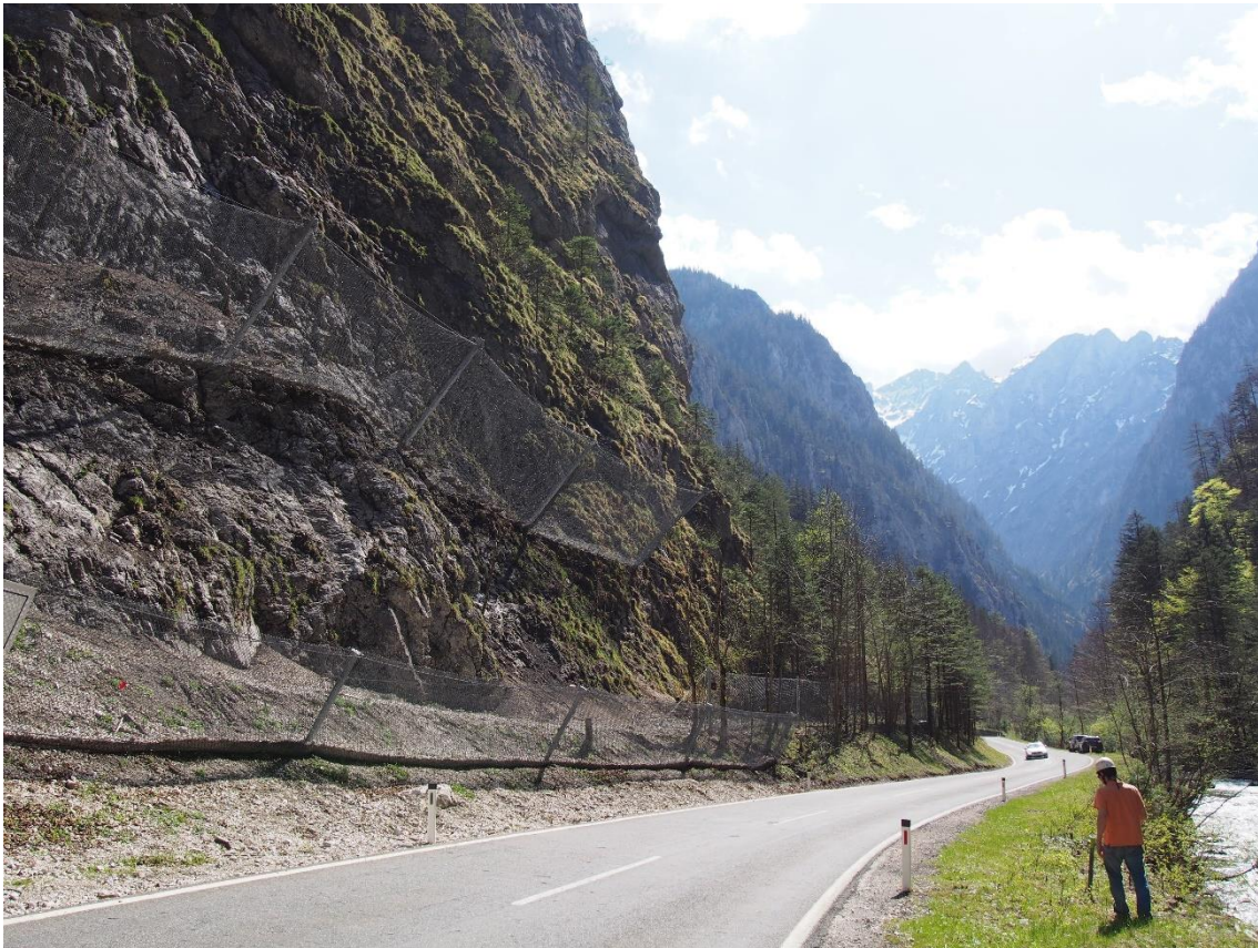
Abbildung 10: Aktuelle Sicherungsmaßnahmen in Form von Steinschlagschutznetzen entlang der L127, Blickrichtung SO
