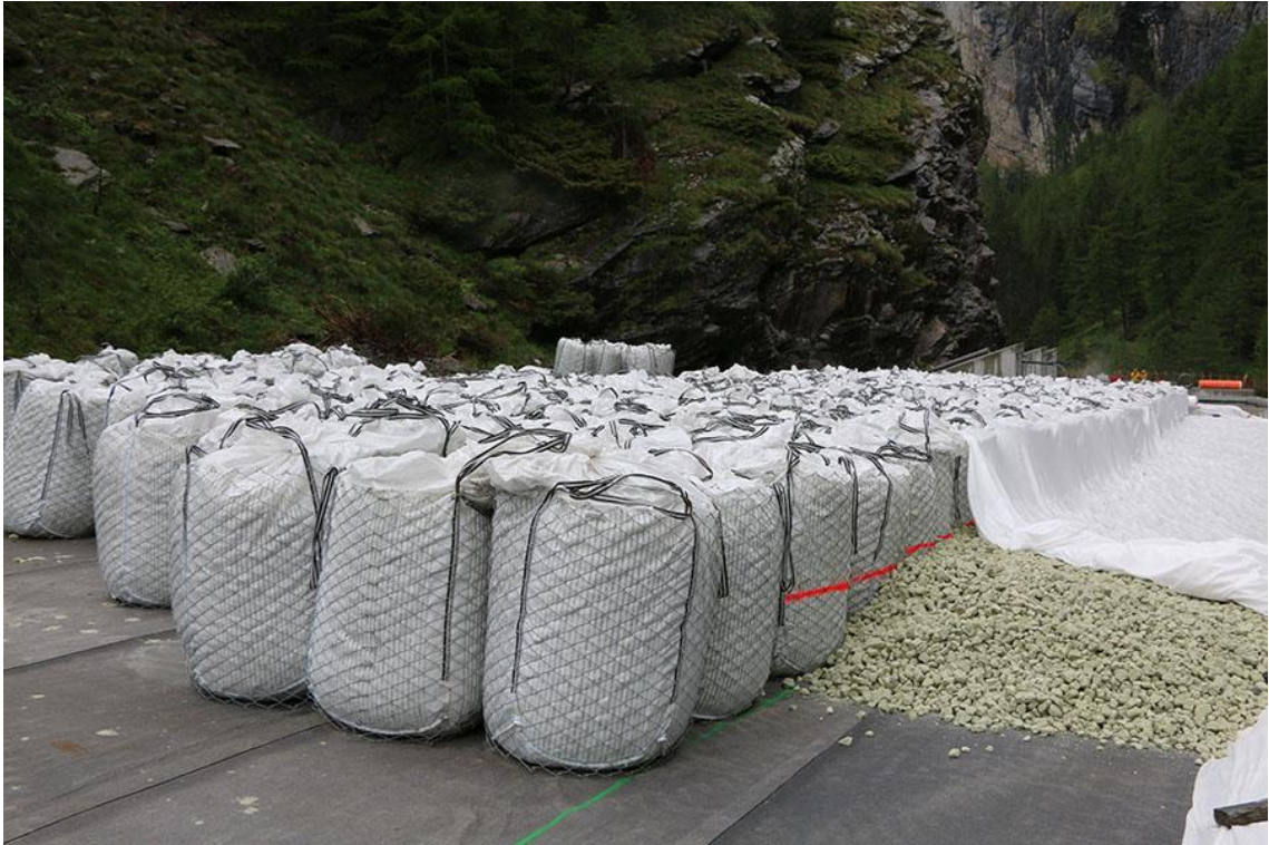
Abbildung 73: Schaumglass-Dämpfungsmodule der Simplon-Galerie [44]
