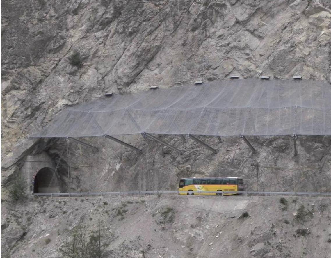
Abbildung 70: Schutznetzüberdeckung im Bereich des Tunnelportals, Val d'Anniviers im Wallis / Schweiz [39]
