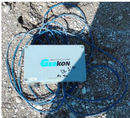
Abb. 45 Datenlogger mit angeschlossenen Porenwasserdruckgebern
