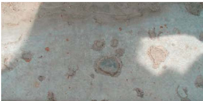
Abbildung 15: Abwitterung einer dünnen Zementschicht über der Gesteinskörnung (Pisarsky, et al., 2007)
