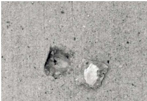
Abbildung 13: Frostschaden Popout der Gesteinskörnung (Pisarsky, et al., 2007)
