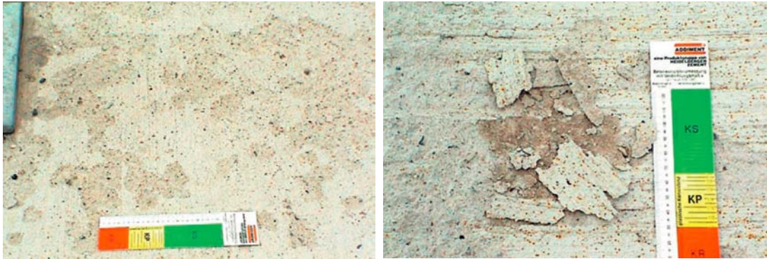
Abbildung 16: Lokale Abwitterung der Kappenoberfläche (links), blättrige Abwitterung (rechts) (Pisarsky, et al., 2007)
