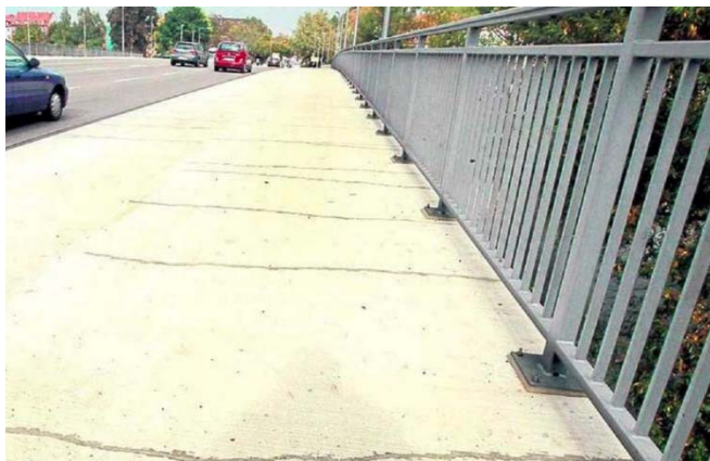
Abbildung 17: Risse infolge Zwangspannungen (Youn, 2016)
