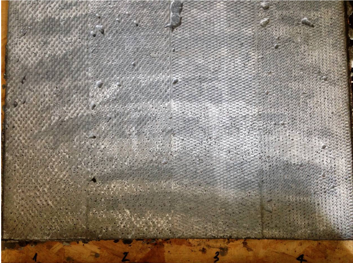
Abbildung 62: verschiedene, raue Oberflächen des Betons und Luftblasen in Abhängigkeit der Stahlplatte
