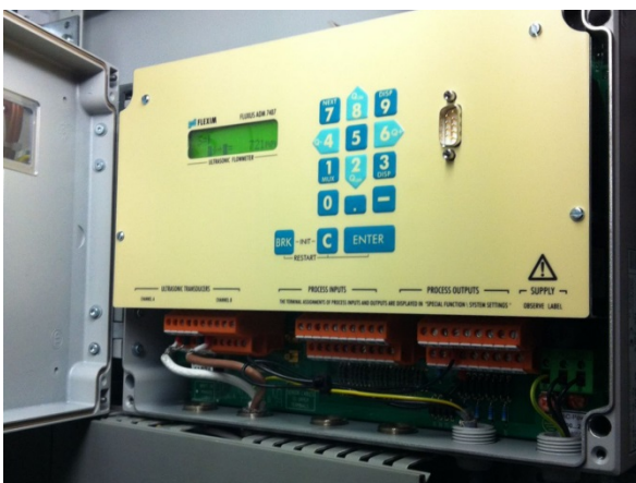
Abbildung 6-3: Auswerteeinheit der fix installierten Durchflussmessung
