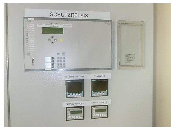
Abbildung 6-6: Schutzgerät und Leistungsanzeigen
