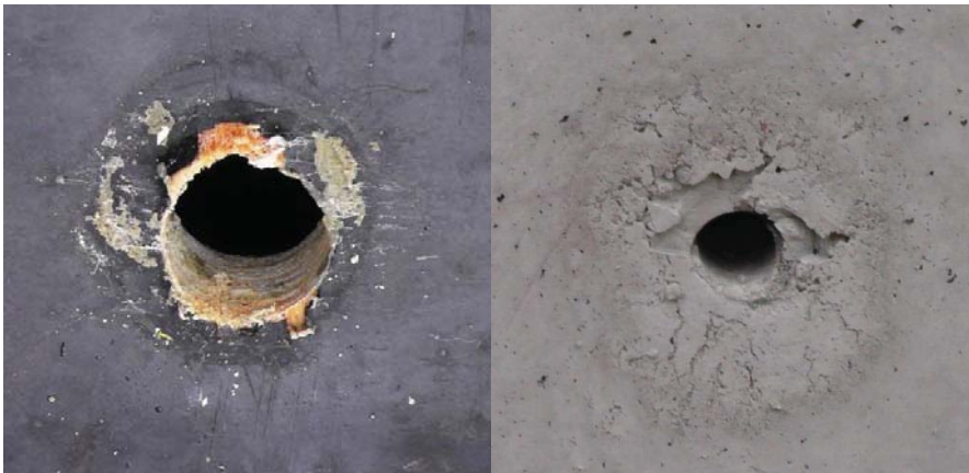
Abbildung 4.58 Ankerloch bei Verwendung einer alten Schalntafel Links: Schalntafel; Rechts: Ergebnis
