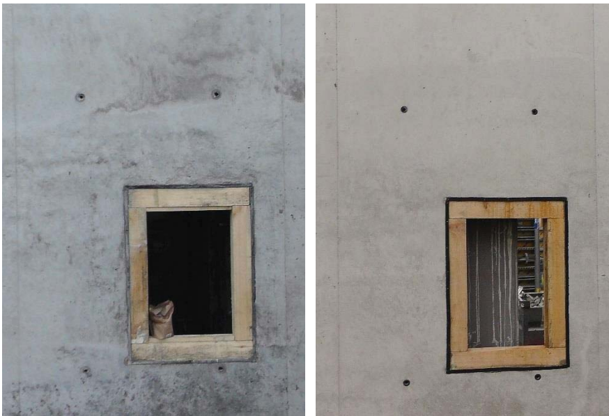
Abbildung 4.61 Farbunterschiede bei verschiedenen Betonlieferanten Links: Beton der Fa. Schwarzl; Rechts: Beton der Fa. Cemex
