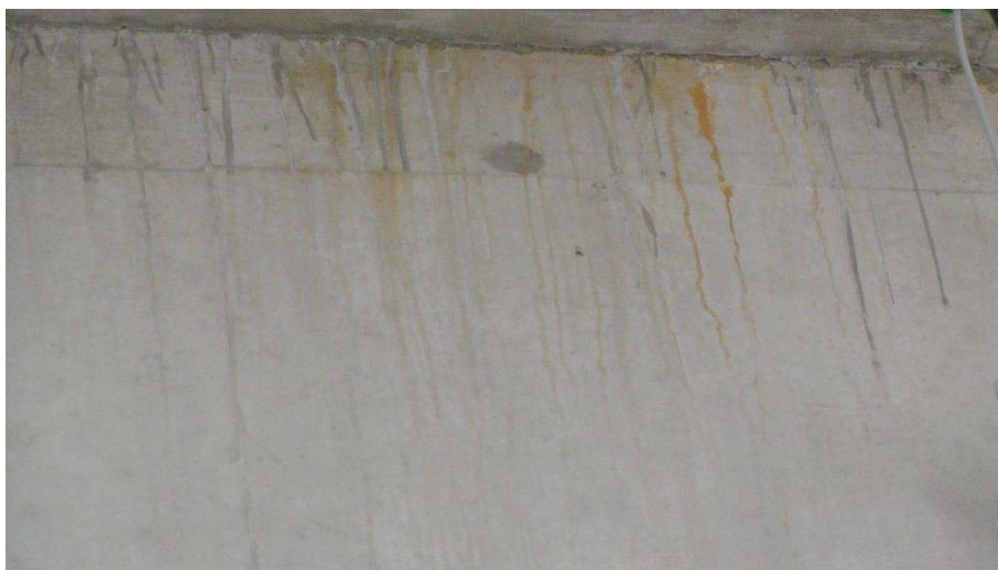
Abbildung 5.33 Rostfahnen durch Kontakt der Bewehrung mit Regen
