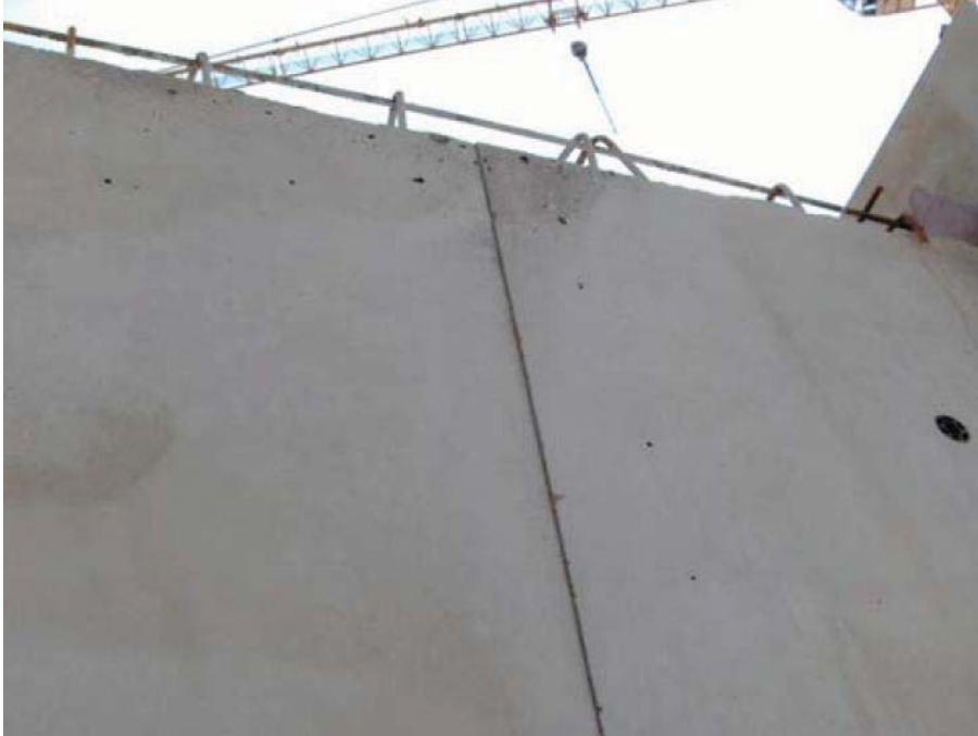
Abbildung 3.11 Schalungselementstoß ES2 (geringer Versatz und Feinmörtelaustritt)
