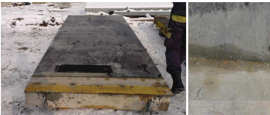
Abbildung 4.18 Starke Verschmutzung der Schalung im 10. OG, Bauteil 2
