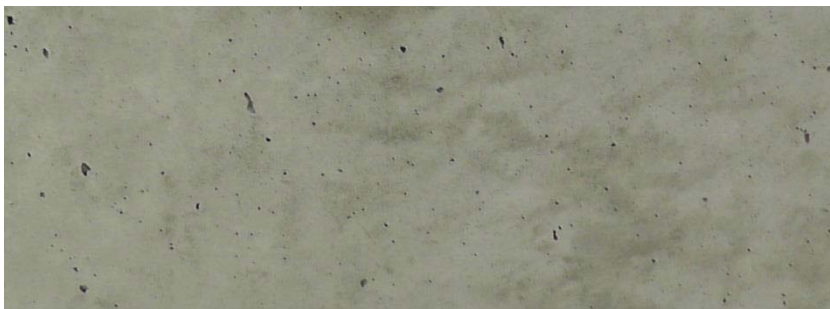
Abbildung 4.54 Porigkeit bei der fünften Verwendung der Schalhaut
