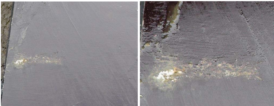
Abbildung 4.7 Beschädigte Schalhaut im 11. OG, Bauteil 2
