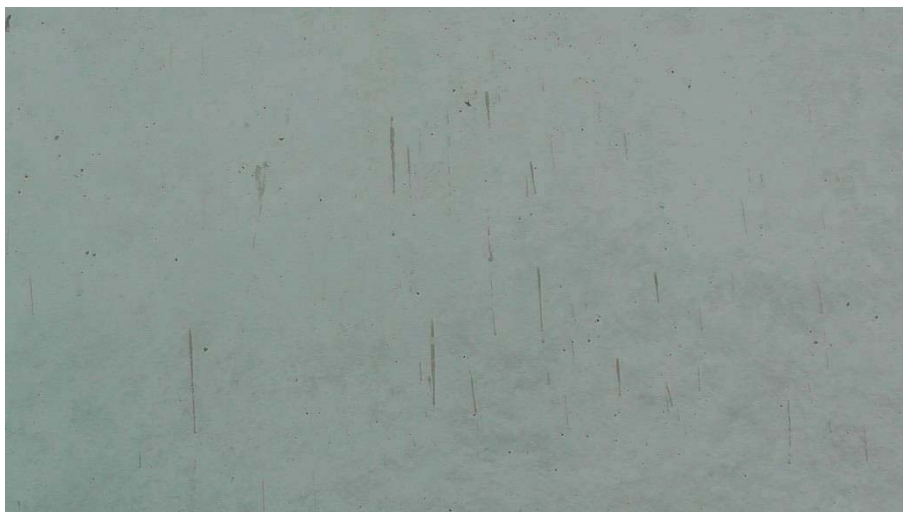
Abbildung 5.35 Betonspritzer an fertiger Sichtbetonwand
