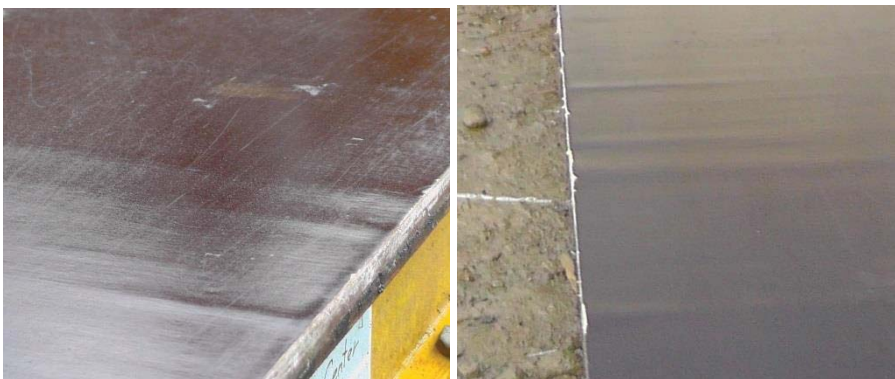
Abbildung 4.8 Ripplings an der Schalhaut
