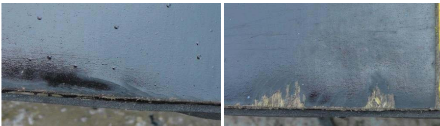
Abbildung 4.98 Schäden an der Schalhaut
