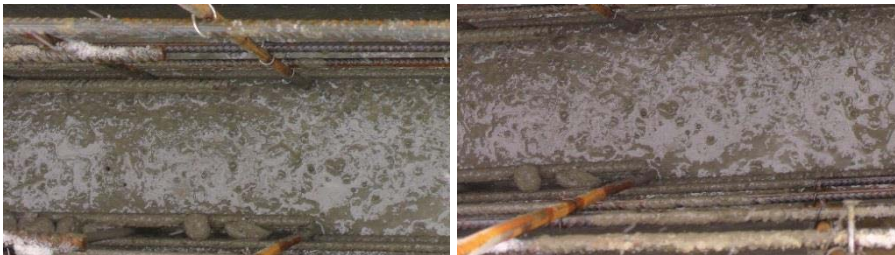
Abbildung 4.26 Wasserabsonderungen aufgrund des Schneefalls
