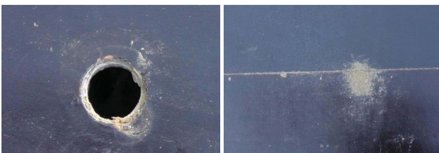
Abbildung 4.100 Schäden an der Schalhaut
