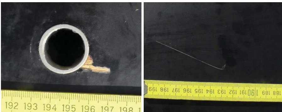
Abbildung 4.78 Schäden an der Schalhaut
