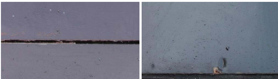
Abbildung 4.97 Schäden an der Schalhaut
