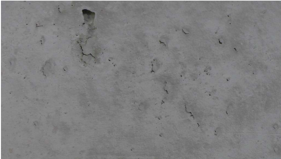
Bild 4.1 Abplatzungen im 14. OG
