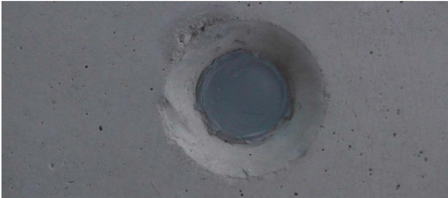
Abbildung 3.31 Ankerloch im Stiegenhaus
