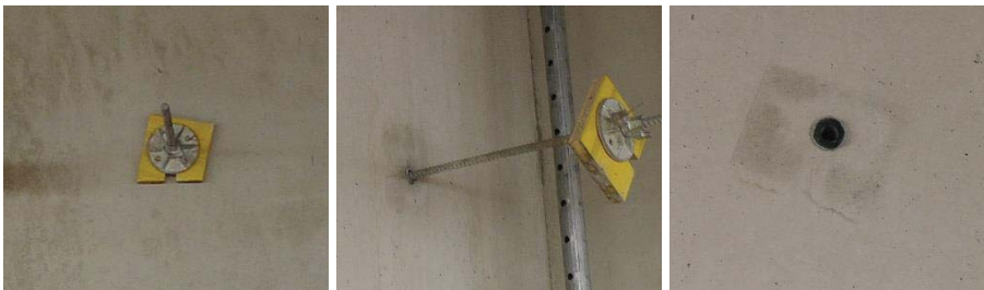
Abbildung 4.84 Abdruck einer Schalttafel
