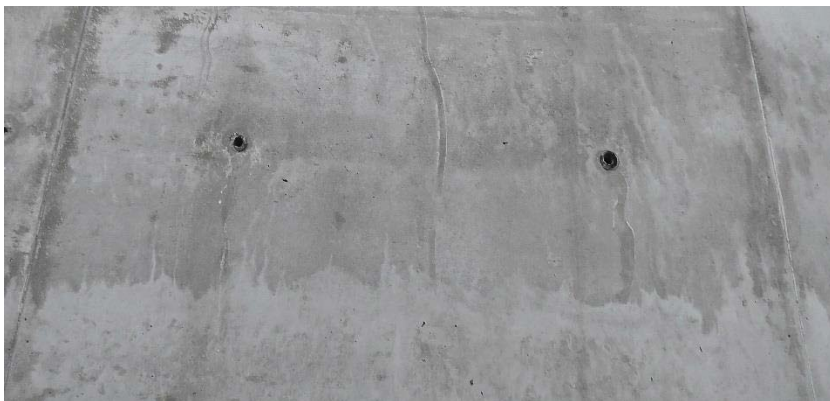
Abbildung 4.33 Dunkle Verfärbungen im 11. OG, Bauteil 1
