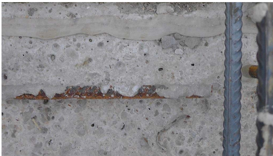
Abbildung 5.50 Silikonwulst an der Betonkrone
