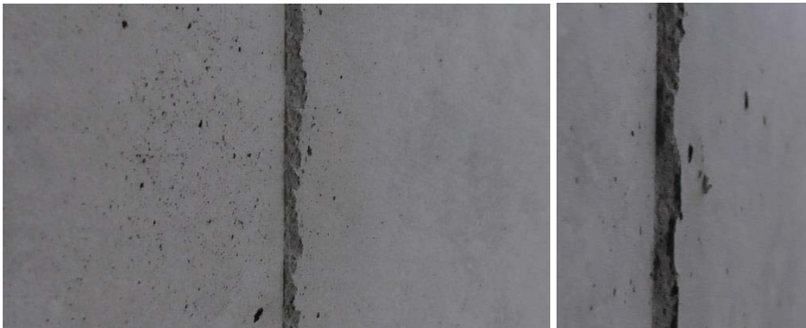
Abbildung 4.14 Fugenversatz im 10. OG, Bauteil 2
