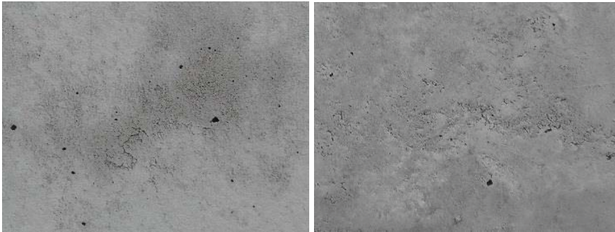
Abbildung 4.43 Kiesnester im 11. OG, Bauteil 2
