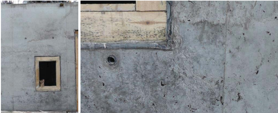
Abbildung 4.30 Kiesnester im 11. OG, Bauteil 1
