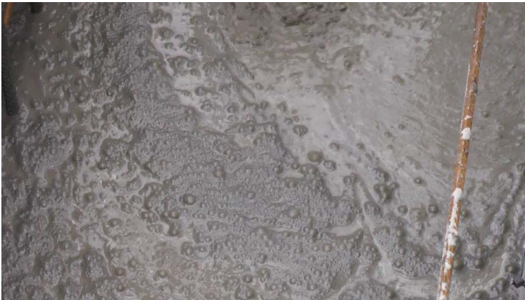
Abbildung 4.5 Blasenbildung an der Frischbetonoberfläche
