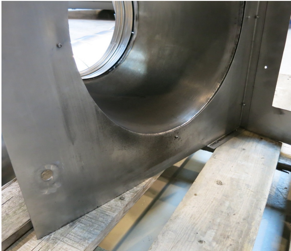
Abbildung 5-6 Ablagerung am Gehäuse in radialer Richtung
