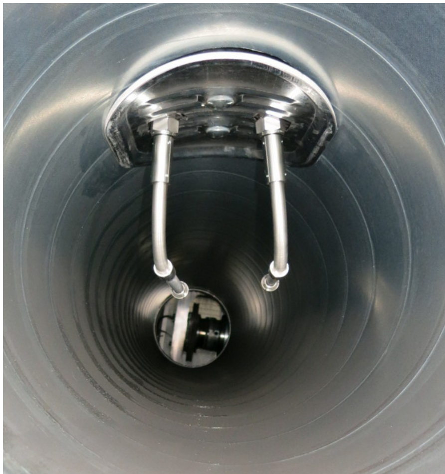
Abbildung 4-13 Entnahmestelle der Probe im Abluftsystem
