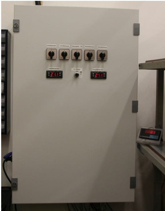
Abbildung 5-8: Elektroverteiler der Strömungsmodellanlage
