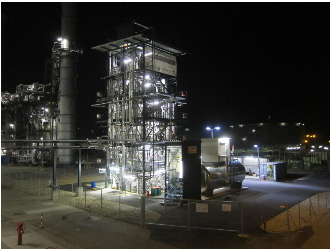
Abbildung 4.4: Die bioCRACK-Pilotanlage am Raffineriestandort Schwechat - bei Nacht
