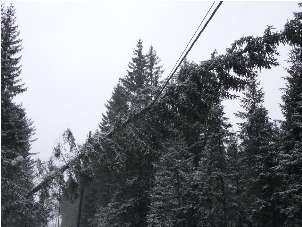
Abbildung 2.5.: Baumfall in Luftkabel, ©Linz Stom Netz GmbH
