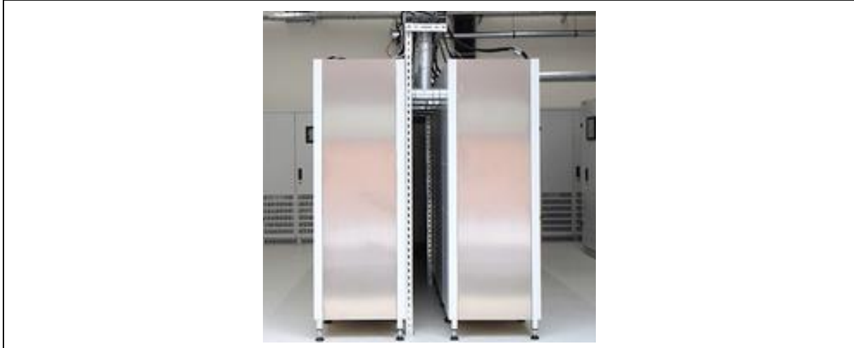
Abbildung 123: Industriespeicher Mobility House 417
