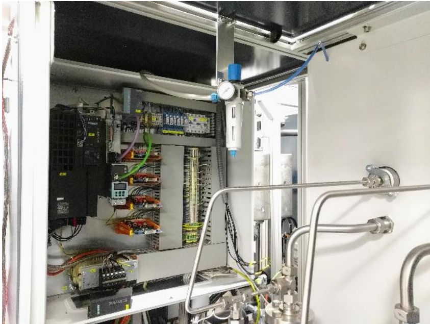
Abbildung 7.8.: Zusätzlicher Verteilerschrank für Erweiterung Pumpenprüfstand
