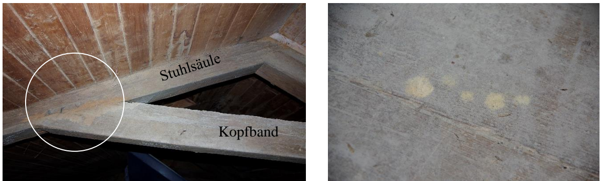
Abbildung 4-83: Nagekäferbefall am VG 11, rechts: Bohrmehl
