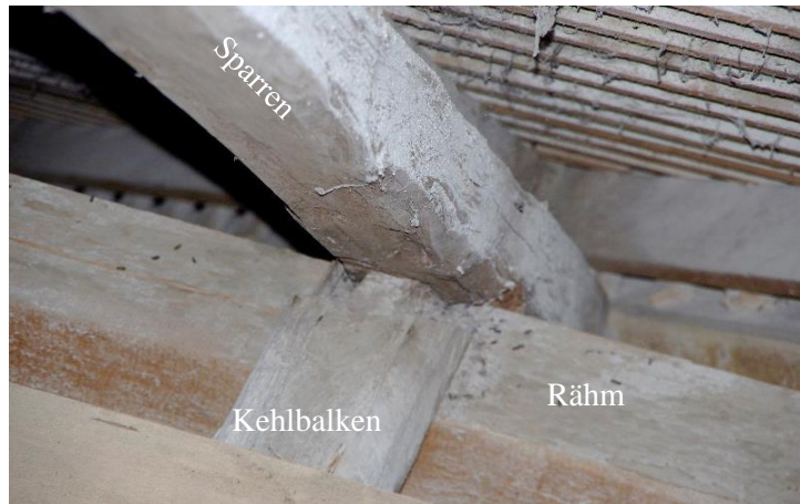
Abbildung 4-88: fehlende Verbindung Kehlbalken mit Rähm, Sparren
