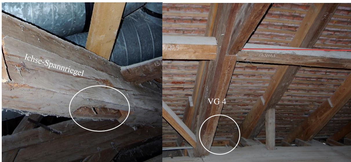
Abbildung 4-94: links: fehlendes Kopfband I.1, rechts: fehlende Windstrebe
