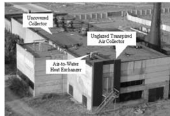
Abb. 2: Versuchsanlage auf dem 12 MW Heizwerk „Rotor“ in Bishkek (Kirgisistan) (Quelle [2]).
