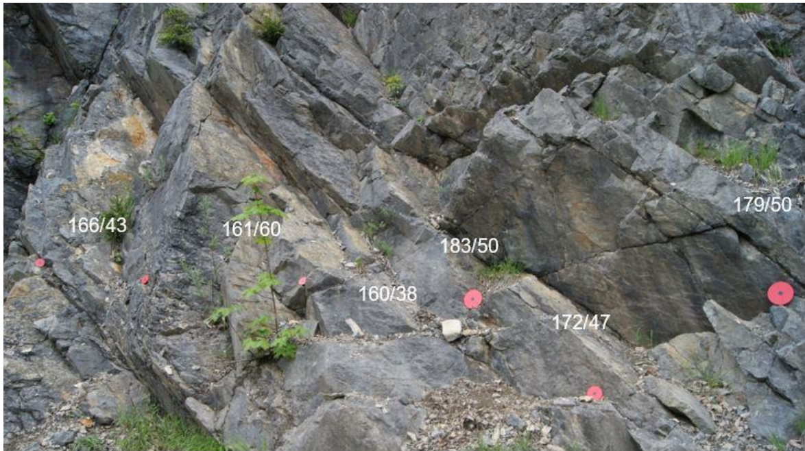
Abbildung 7.1: Darstellung der gemessenen Orientierungen der Schichtflächen im Zuge des Scanline Mappings. Der Durchmesser der roten Scheibe am rechten Bildrand beträgt 16 cm.
