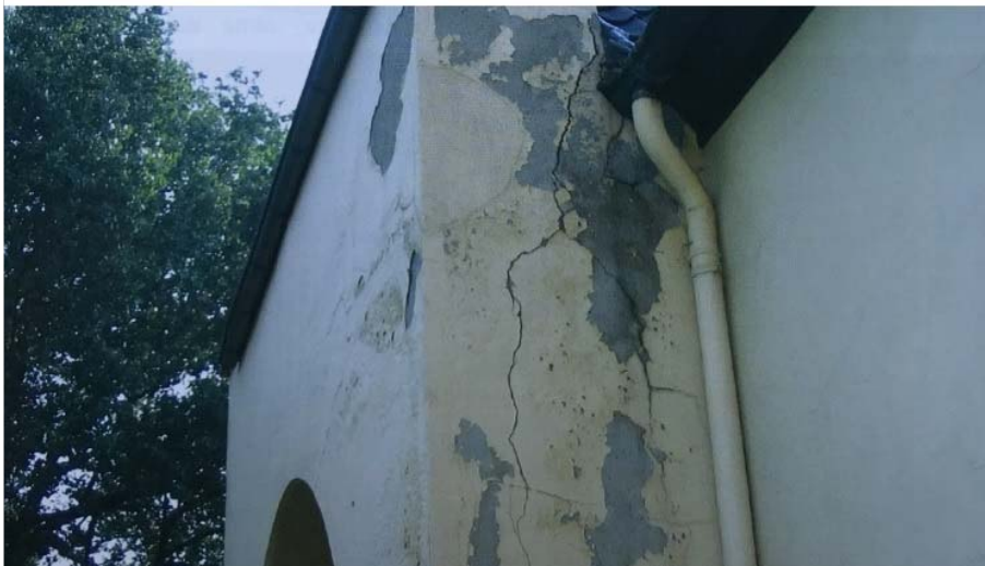
Bild 5-14: Setzungsrisse bei einer Muldenlage 209
