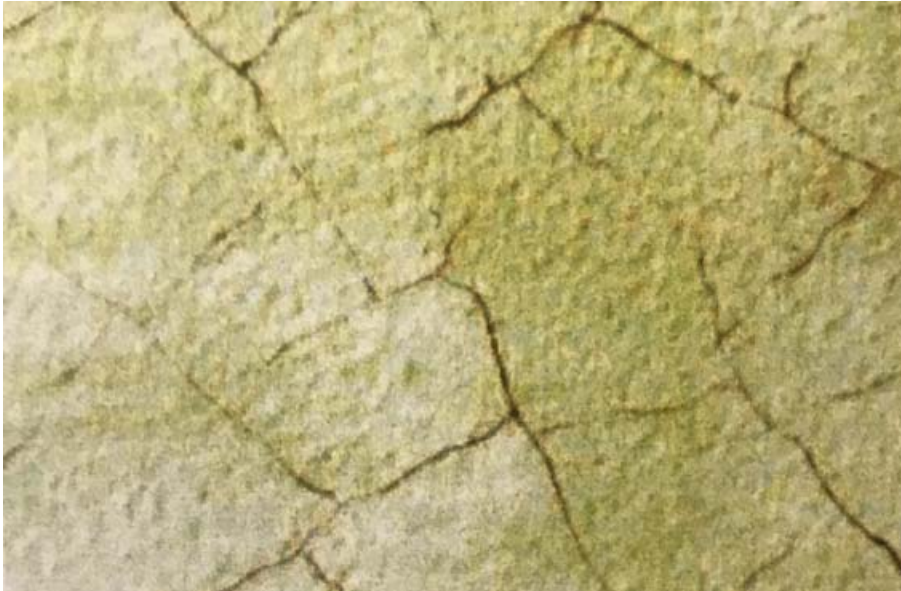
Bild 5-26: Netzartige Schwindrisse im Unterputz 231
