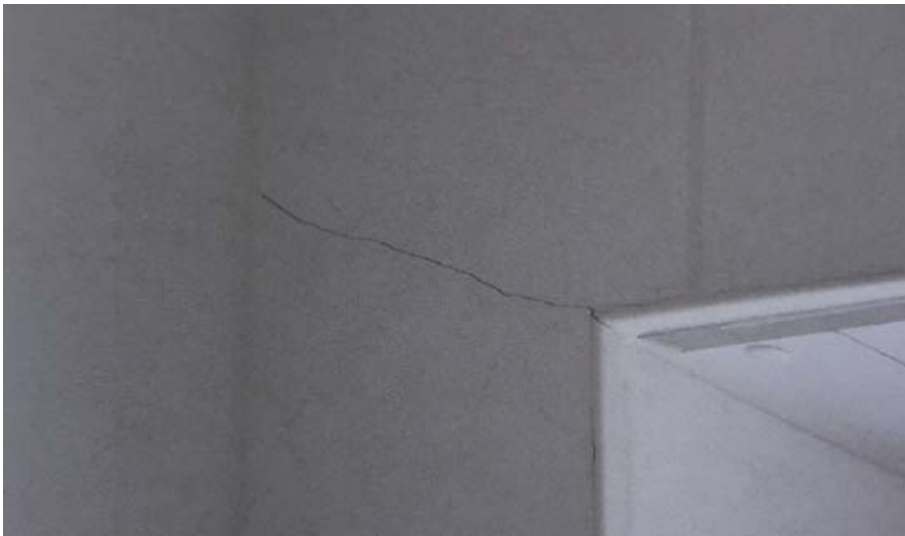
Bild 5-6: Rissbild durch unterschiedliche Längenänderung am Beispiel eines Kerbrisses im Fensteranschlussbereich 195
