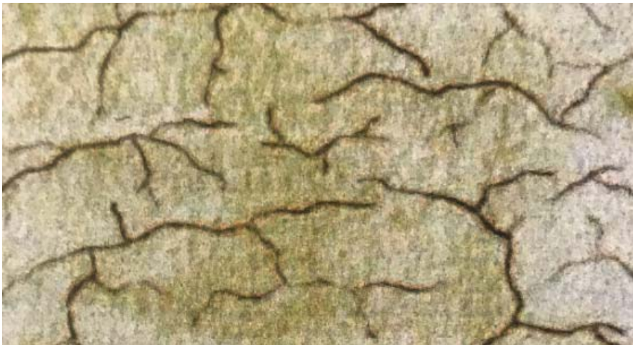
Bild 5-25: Schwindriss im frühen Zustand (Schrumpfriss) 229
