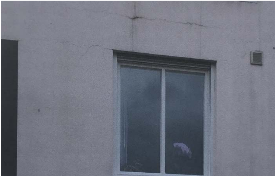
Bild 5-9: Lastabhängig verursachte Rissbildungen 200
