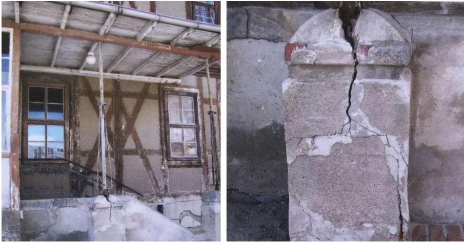
Bild 5-5: Schadensbild an der linken Pfeilerkonstruktion der Überdachung 191
