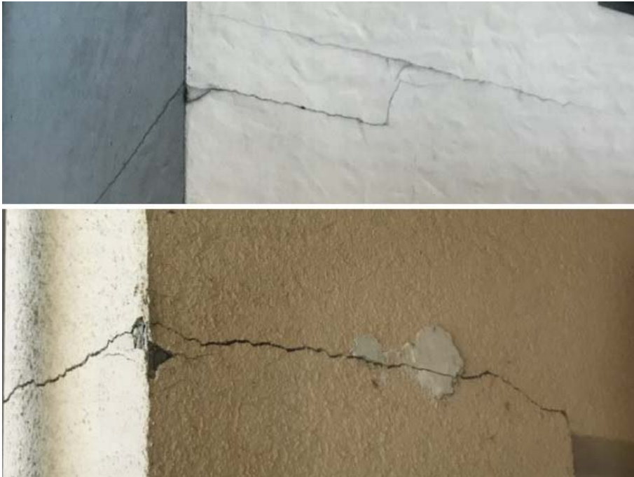
Bild 5-23: Horizontalriss durch Abheben der Stahlbetondecke im Auflagerbereich oder in der Wandfläche 224
