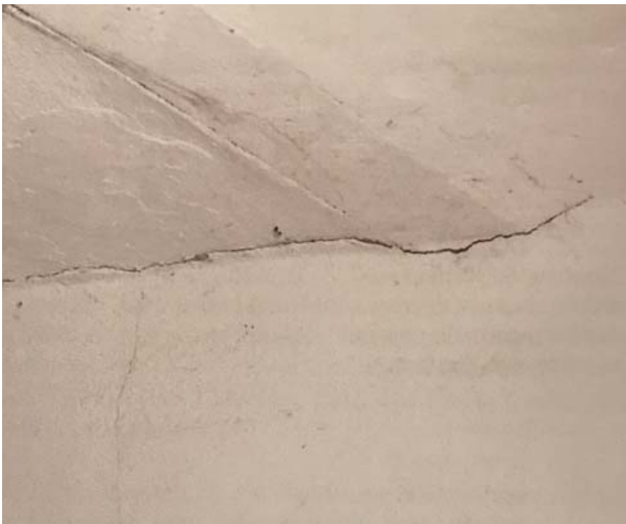
Bild 5-20: Schubriss (hier Deckenschubriss) 221
