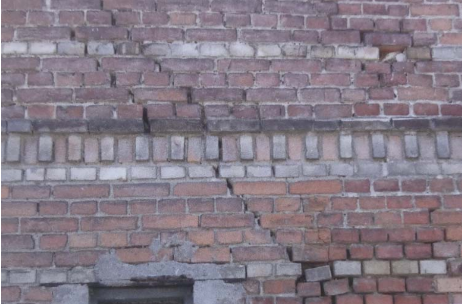
Bild 5-18: Setzungsrisse im Mauerwerk 217
