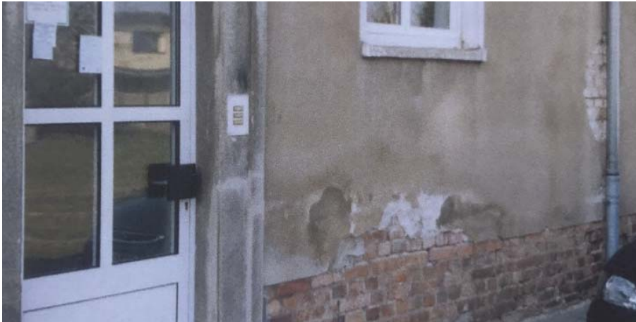
Bild 5-7: Rissbildung und Putzablösung durch Salzeinwirkung 197
