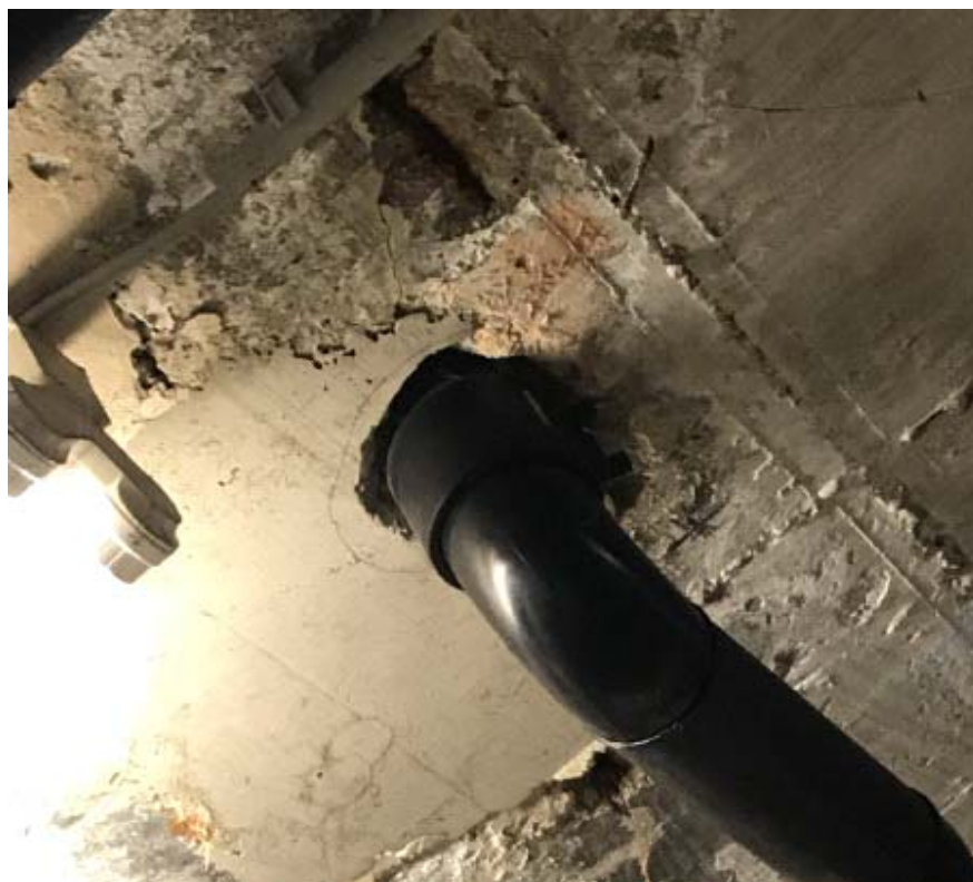
Bild 6-16: Wasserschaden bei einer Stahlbetondecke 321
