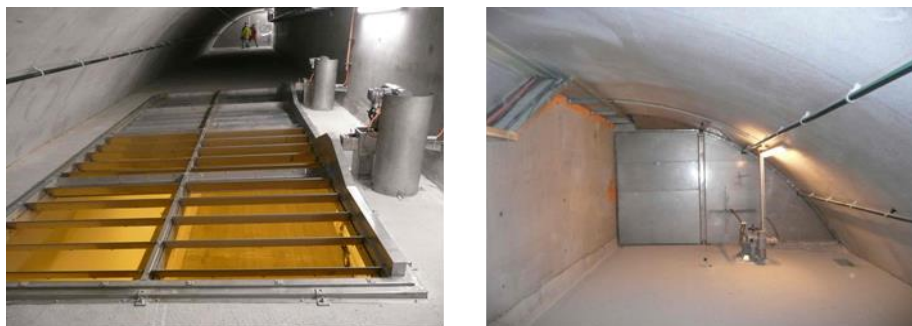
Abbildung 5-1: Beispiel eines IK-Systems mit der Frischluftimpulsklappe links und der Kanalabsperrrklappe rechts [Sturm, Beyer, Bacher & Schmölzer, 2012].
