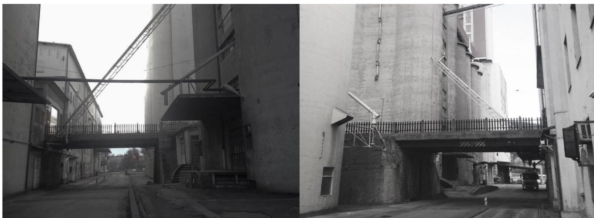
Abb.11 u. 12: Alte Anlieferung Brücke, die sichtbaren Schäden an der Konstruktion hat.
