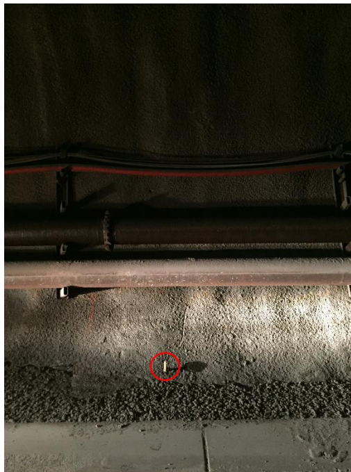
Abbildung 51: Aufgeplatzte Spritzbetonschale mit saniertem Mörtelbeet - MQ 3
