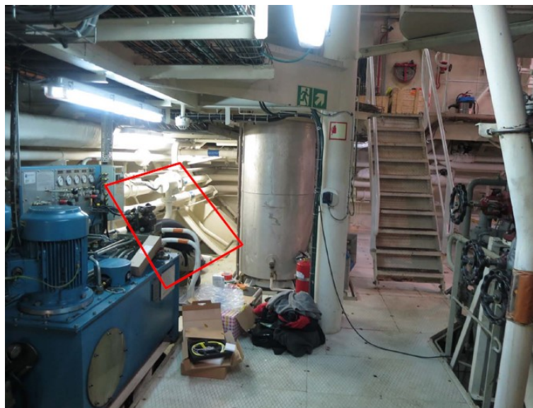
Abb. 6.2: Position der FBG Sensoren im Maschinenraum (Foto: Ferdinand Klug)
