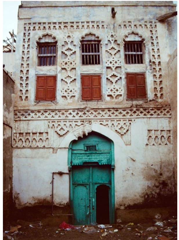
Abb. 259 Dieses historische Haus mit seiner sehr aufwendig gestalteten Fassade wirkte heruntergekommen und eingesunken. Das Tor mit zwei integrierten Gehrten vermorschte unten bereits. Das Umgebungsniveau steigt stetig an, weil das Gemisch aus Müll, Staub und Sand aus der Wüste nicht beseitigt, sondern nur durch passierende Fahrzeuge zusammengepresst wurde. Aufsteigende Feuchtigkeit setzte daher den Ornamenten der unteren Fassade und dem Holztor bereits stark zu.
