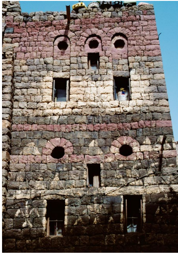
Abb. 273 Dieser Dekor wird vor allem durch die Verwendung von Natursteinen unterschiedlicher Färbung, aber auch durch farbliche Bemalung erreicht. Vielleicht war im unteren Teil der Fassade einmal ein Gesicht intendiert?
