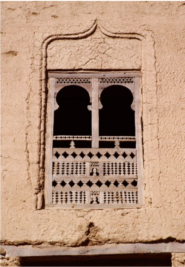
Abb. 90 Ein Fenster in dem zerfallenden Palast in Tarim von außen.
