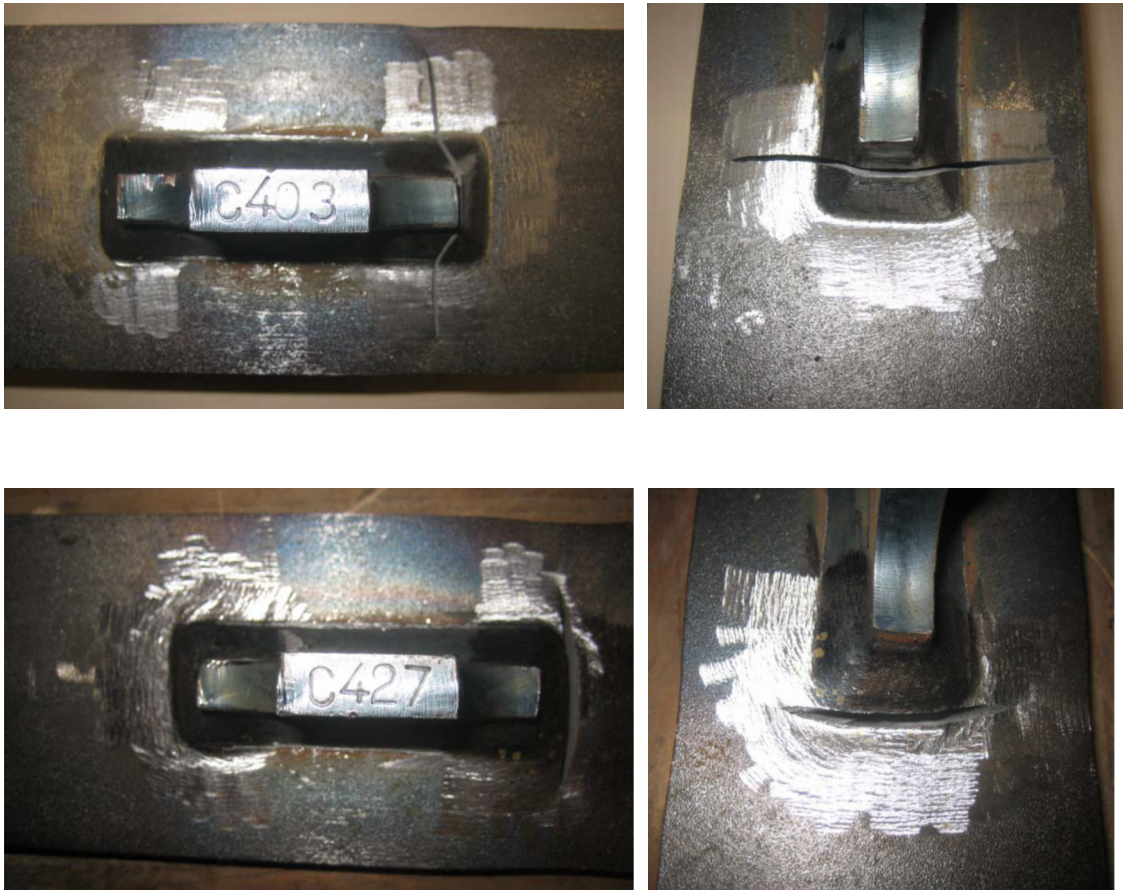
Abbildung 37 Wurzelriss (oben) bzw. Nahtübergangsriss (unten)
