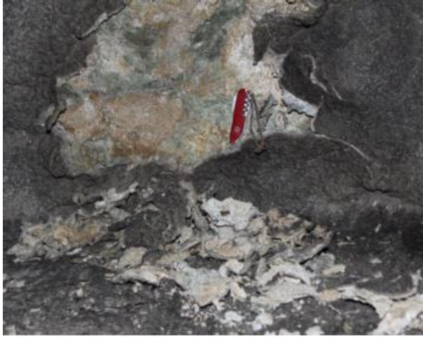
Abbildung 32: Abgefallener Spritzbeton in einer Tunnelnische des Bosrucktunnell, Österreich
