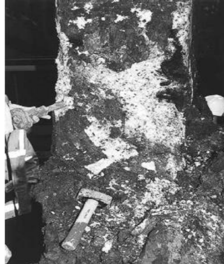
Abbildung 33: Schaden durch Thaumasitbildung am Fundament eines 29 Jahre alten Brückenpfeilers, der Feuchtigkeit ausgesetzt, Gloucestershire, GB
