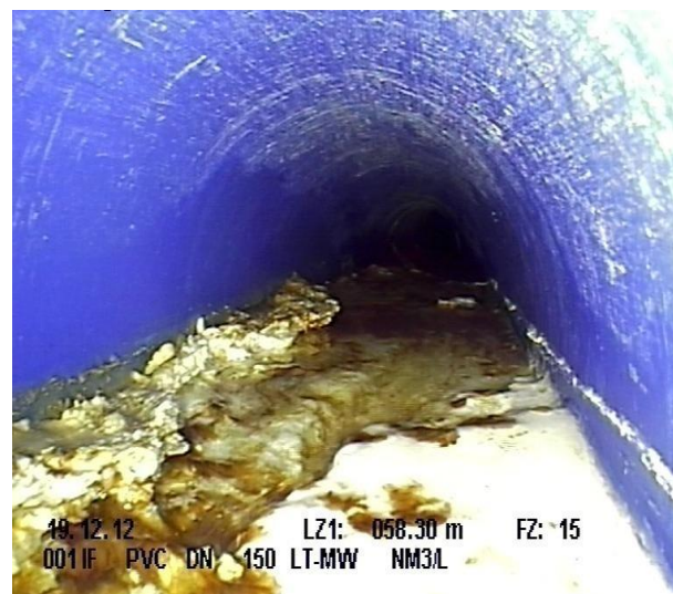
Abbildung 29: Aufnahme einer Kamerabefahrung der Ulmendrainage in der Markwardstiege (Bauverlag BV GmbH, 2012)
