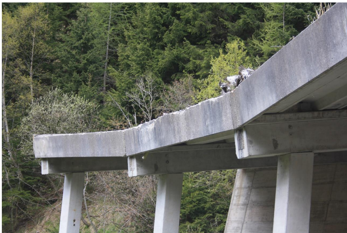
Abbildung 14: Sichtbare Beschädigungen, die durch Steinschläge verursacht worden sind (Bild: Liu 2016)
