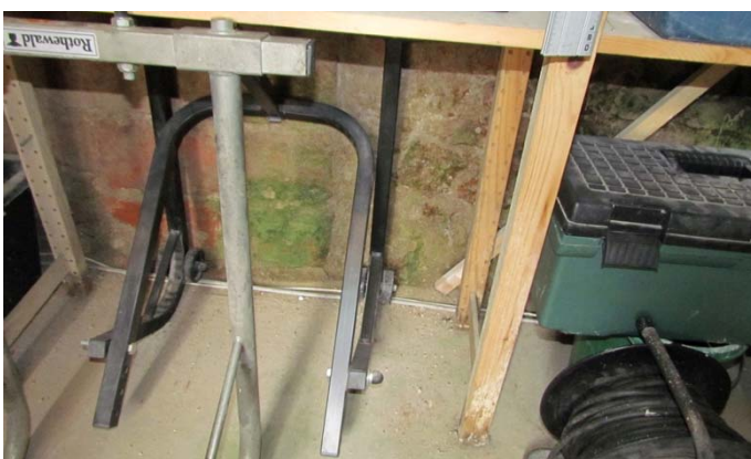
Abb. 45: Lagerräume I – Feuchteschäden
