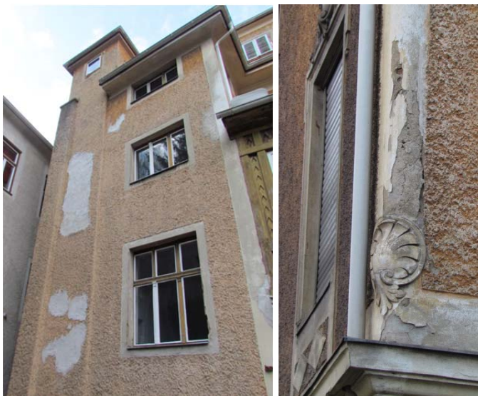
Abb. 77: Nordfassade mit Verputzschäden
