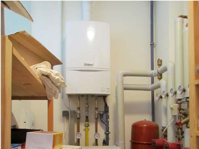
Abb. 66: Top 3, Gastherme (BJ 2006) im Abstellraum
