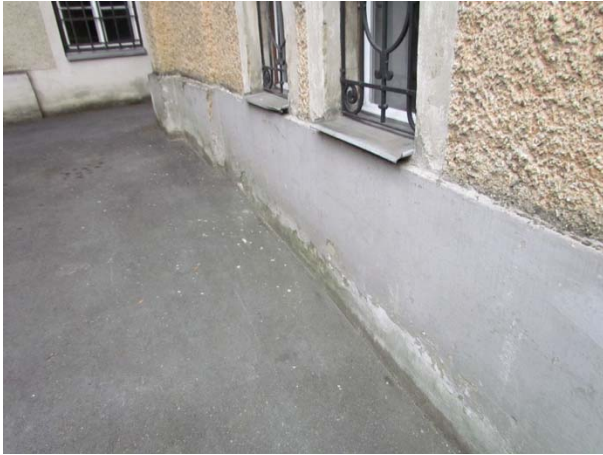
Abb. 79: Sockel mit Feuchteschäden
