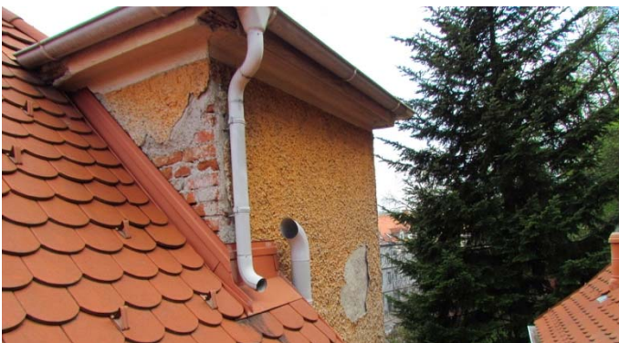
Abb. 81: Fassade mit Schäden
