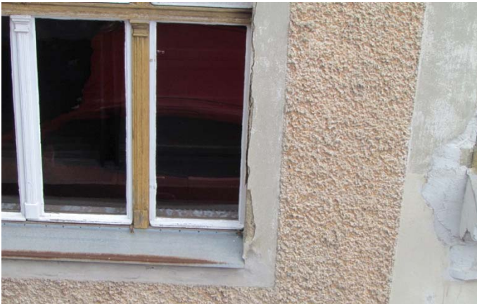
Abb. 80: Fassade und Fenster mit Schäden
