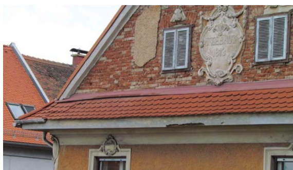
Abb. 78: Südfassade mit Verputzschäden
