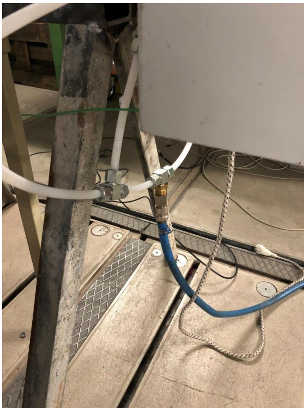
Abbildung 28: Anschluss Druckluft an das Kalibriersystem
