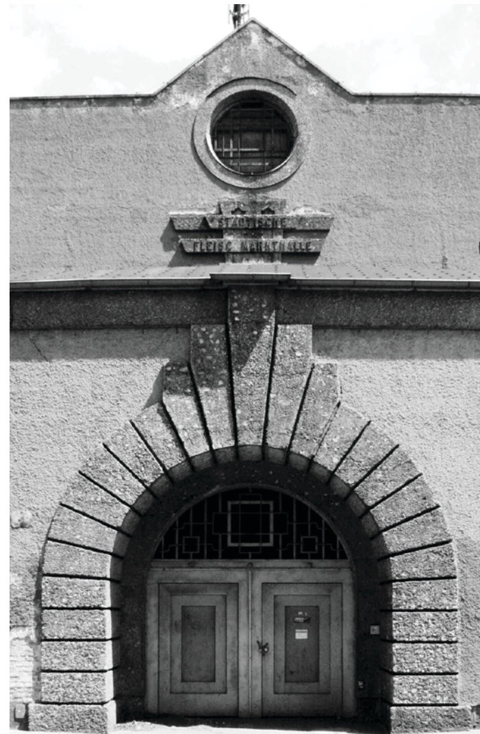
oben: originaler Beleuchtungskörper unten: Attikaentwässerung am Vorbau rechts: Eingangportal mit dahinterliegendem Wappen und Rundfenster an der Blendmauer
