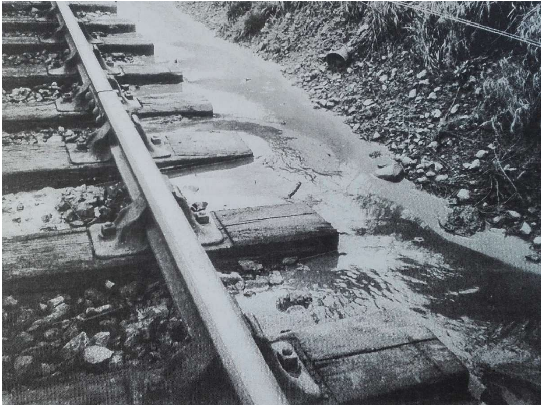
Abb. 3 Schlammstellen auf der Gleisschotteroberfläche (Selig und Waters 1994)
