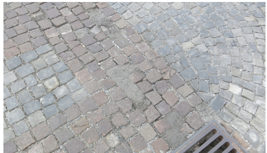
Abb. 80: Bei der Wahl von neuen Bodenbelägen kann auf die praktischen Erfahrungen der Nutzer zurückgegriffen werden
