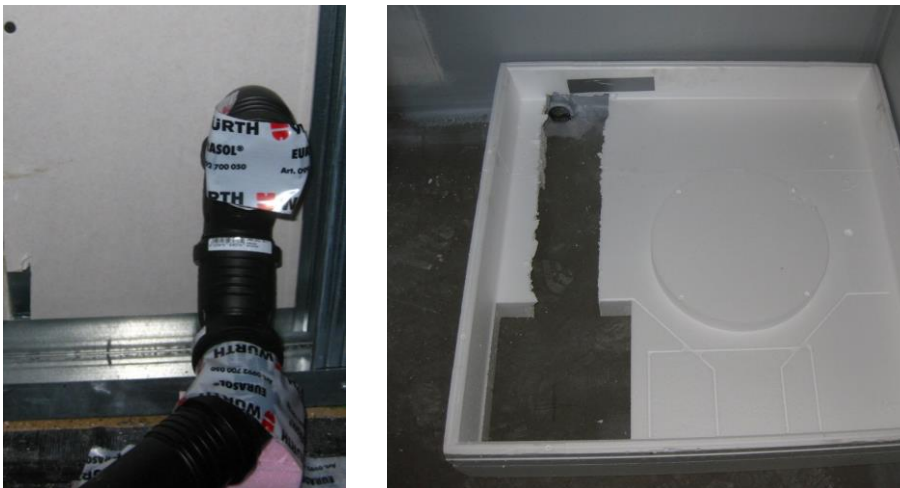
Bild 5.17 Rohrstützen für den Abfluss der Duschtasse (links) und Abfluss der Duschtasse in der Wand (rechts)
