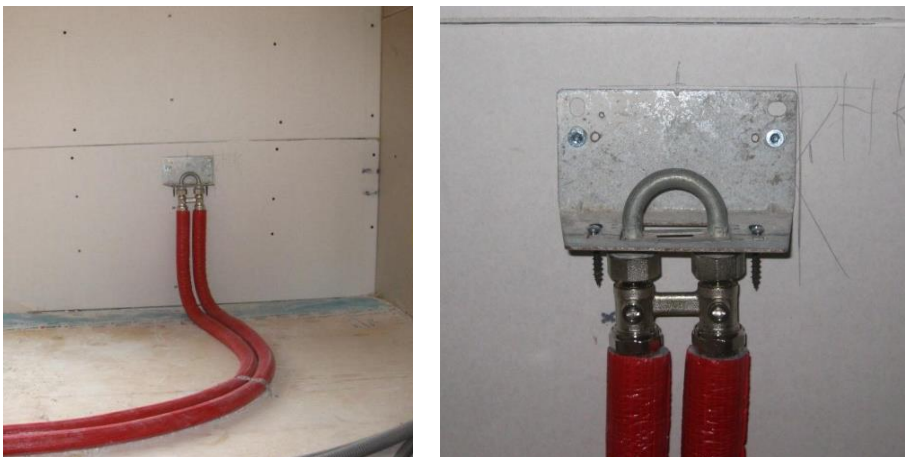
Bild 5.28 Anbindung der Heizkörper in Wohnräumen (links) und Wandkonsole für den Heizkörperanschluss (rechts)
