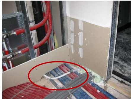
Bild 6.16 Entwässerungsschlauch über den Heizungsleitungen
