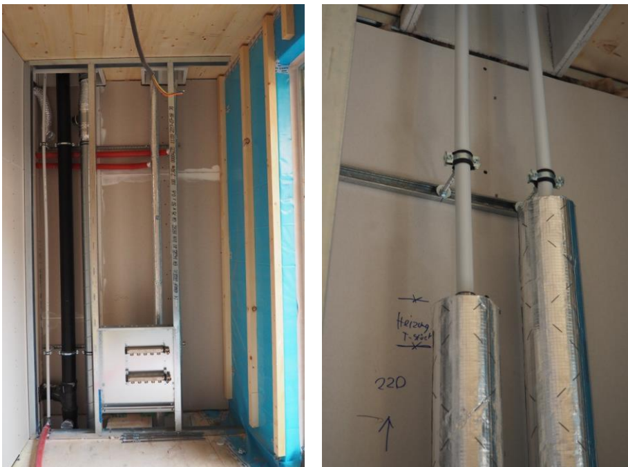
Bild 5.23 Anordnung der Heizungsleitungen im Schacht (links) und Befestigung der Heizungsleitungen an der Schachtrückwand (rechts)
