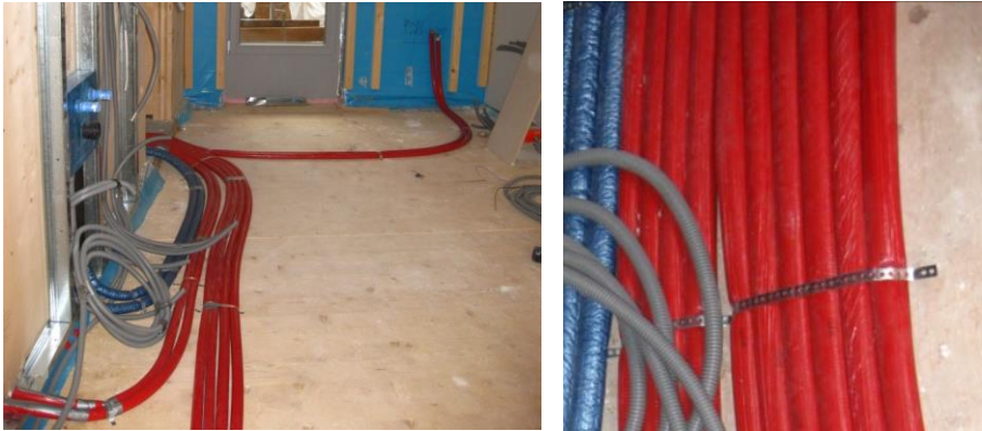
Bild 5.25 Leitungsführung auf der Rohdecke: Vor- und Rücklauf von Heizkörpern (links) und Leitungsbefestigung (rechts)
