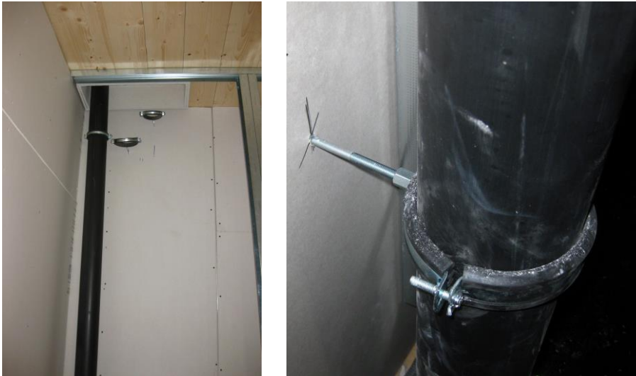
Bild 5.11 Fallleitung im Schacht des Abstellraumes (links) und Rohrbefestigung an der Schachtwand (rechts)
