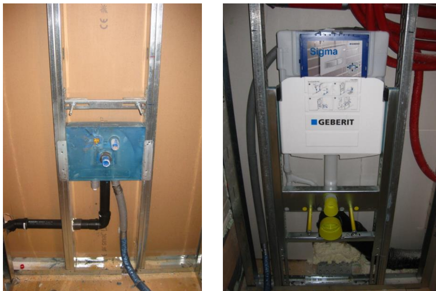
Bild 5.7 Trinkwasserinstallation: WC - Waschtisch (links) und WC - Elemente (rechts)
