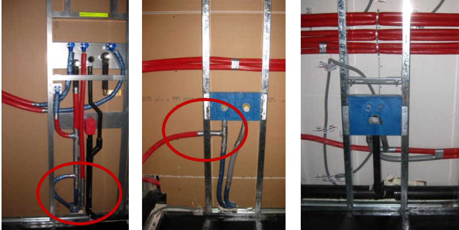
Bild 5.6 Trinkwasserinstallation: Anschluss des Boilers (links), der Badewanne (mitte) und des Waschtischs (rechts)
