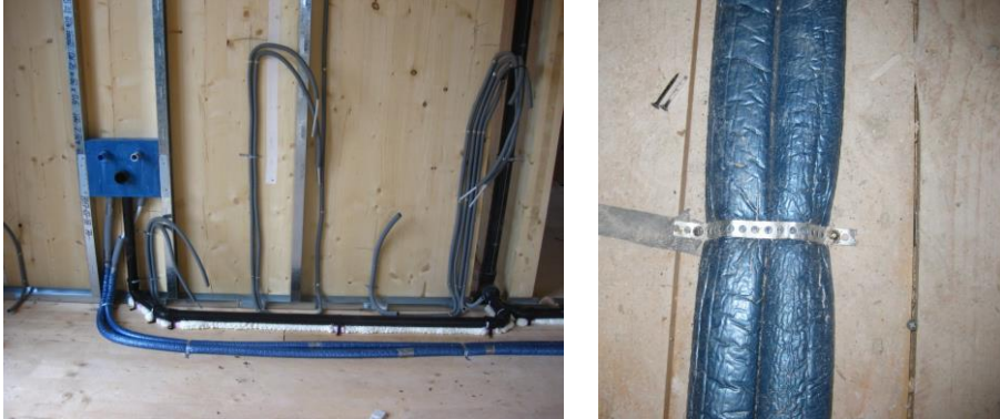
Bild 5.8 Leitungsinstallation in der Küche (links) und Rohrbefestigung auf der Holzmassivdecke (rechts)
