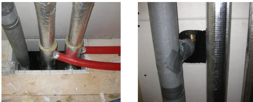
Bild 5.4 Vertikale Verteilung der Trinkwasserinstallation (links) und Durchführung zum Boiler (rechts)
