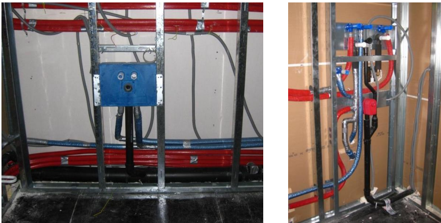
Bild 5.14 Anschluss für den Waschtisch (links) und Boiler- bzw. Waschmaschinenanschluss (rechts)
