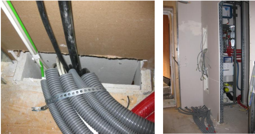
Bild 5.31 Schacht für Elektroinstallationen (links) und Unterputzverteiler (rechts)
