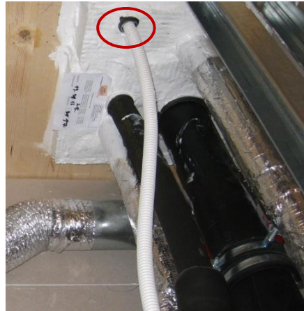
Bild 6.5 Durchdringung der Brandabschottung durch den Entwässerungsschlauch
