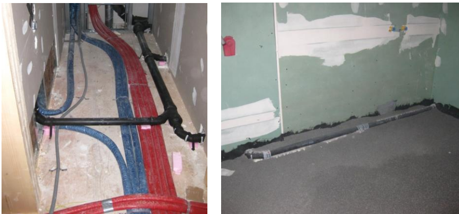
Bild 6.11 Kreuzende Leitungen im Fußbodenaufbau (links) und Abwasserleitung die nicht mit Schüttung bedeckt ist (rechts)
