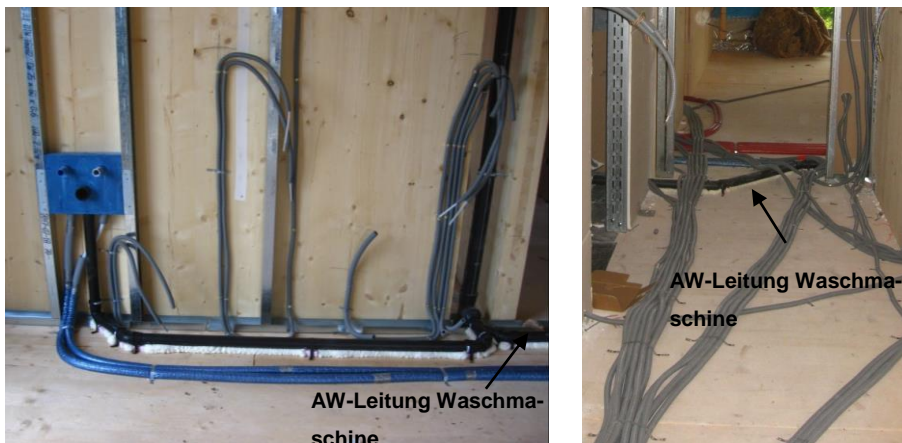
Bild 5.15 Abflussleitung des Waschbeckens in der Küche (links) und Abflussleitung der Waschmaschine (rechts)
