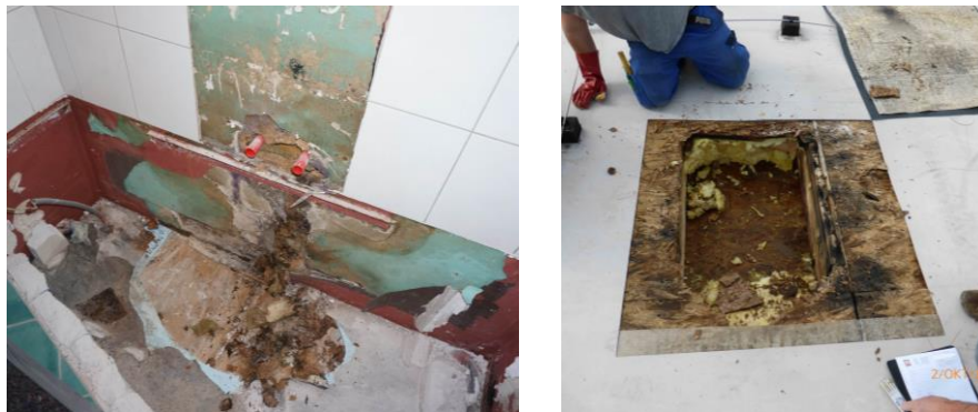
Bild 1.4 Beispiele für Feuchteschäden im Badezimmer (links) und am Dach (rechts) 31
