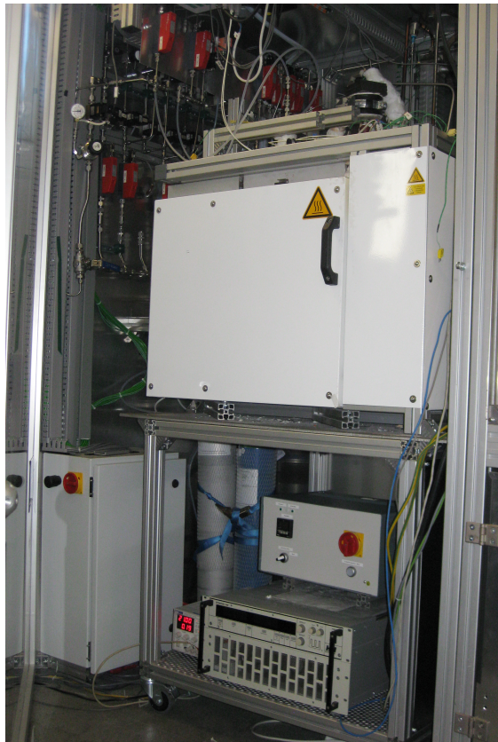
Abbildung 3.7: Foto des Einzelprüfstandes nach den Umbauarbeiten
