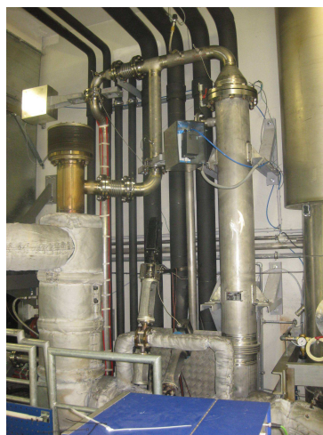
Abbildung 36: AGR Entnahme, Bypassleitung und Kühler
