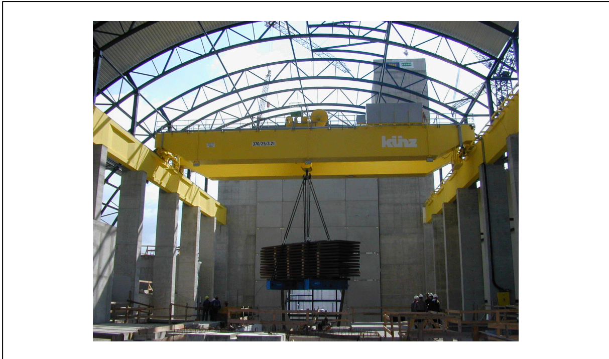
Abbildung 1-3 Maschinenhauskran Siemens AG Wien 6
