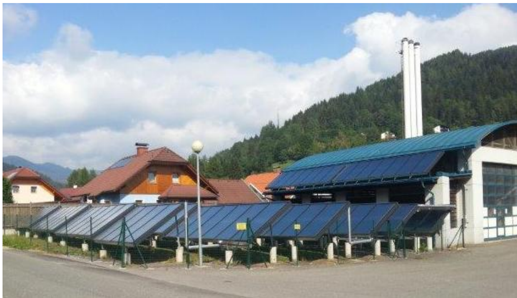
Abbildung 2-10: Biomasseheizwerk Oberzeiring mit solarthermischer Wärmeunterstützung (Weinstich, 2013)
