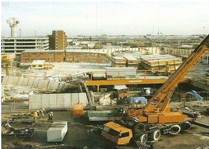
Abbildung 2.5: Einbruchstelle Heathrow Express Link (Parker D. 2016)
