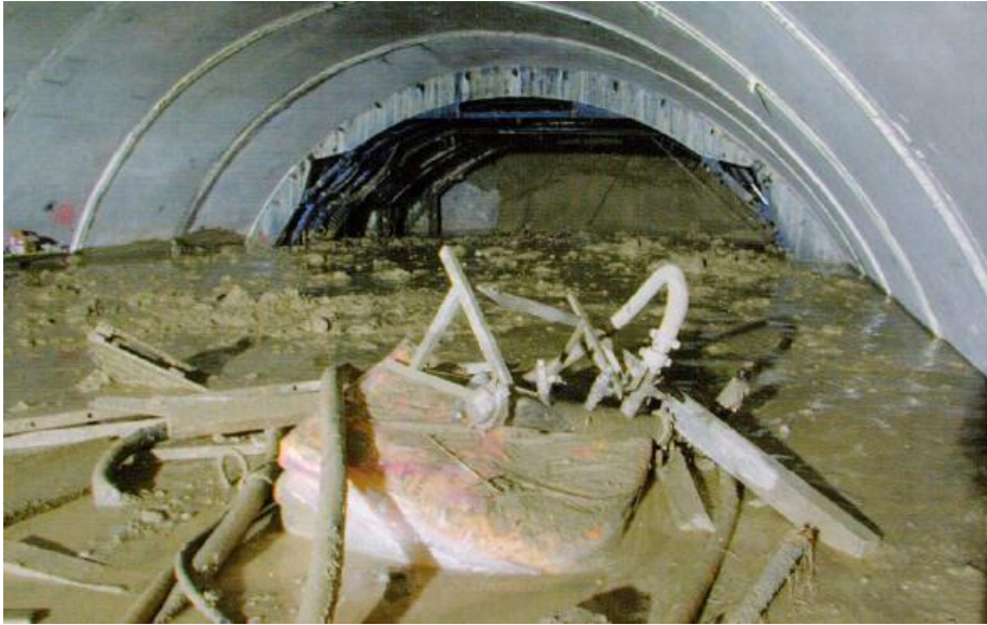
Abbildung 2.6: Teilweise Füllung des Tunnelquerschnitts durch fließendes Gebirge (Schubert W. 2014)
