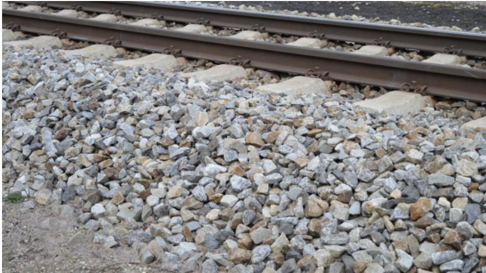
Abbildung 12 Gleis auf Schotterbett [17]
