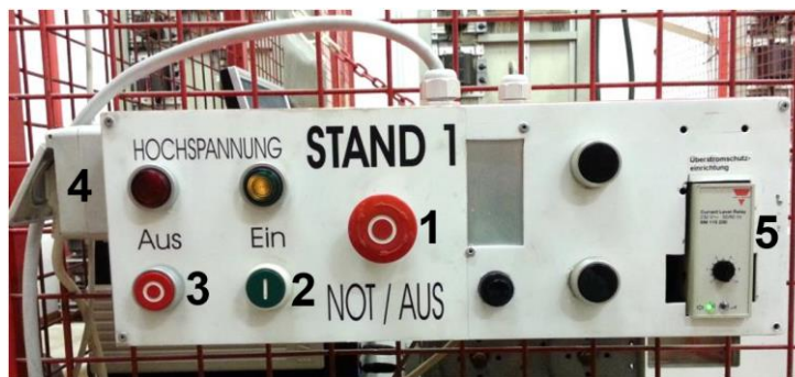
Bild D-1: Hauptsteuereinheit außerhalb des Alterungsprüfstandes
