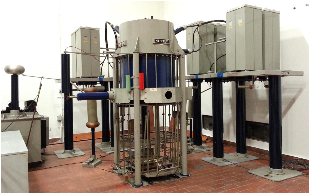
Bild A-1: Stoßstromanlage des Institutes für Hochspannungstechnik und Systemmanagement
