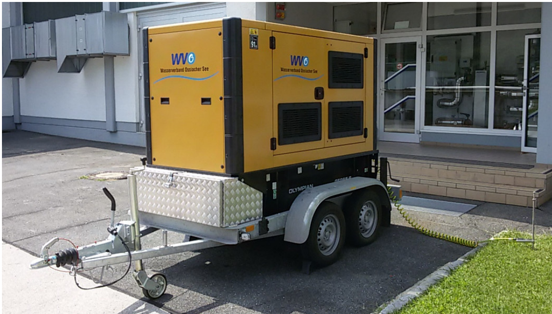
Abbildung 9-5: Mobiles Notstromaggregat (52 kW) des WVO
