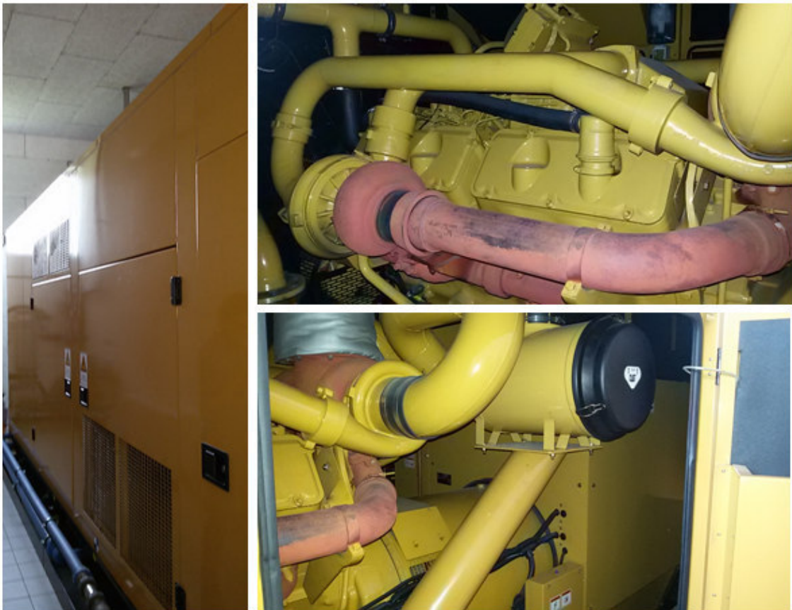
Abbildung 9-4: Stationäres Notstromaggregat (640 kW) auf der ARA des WVO
