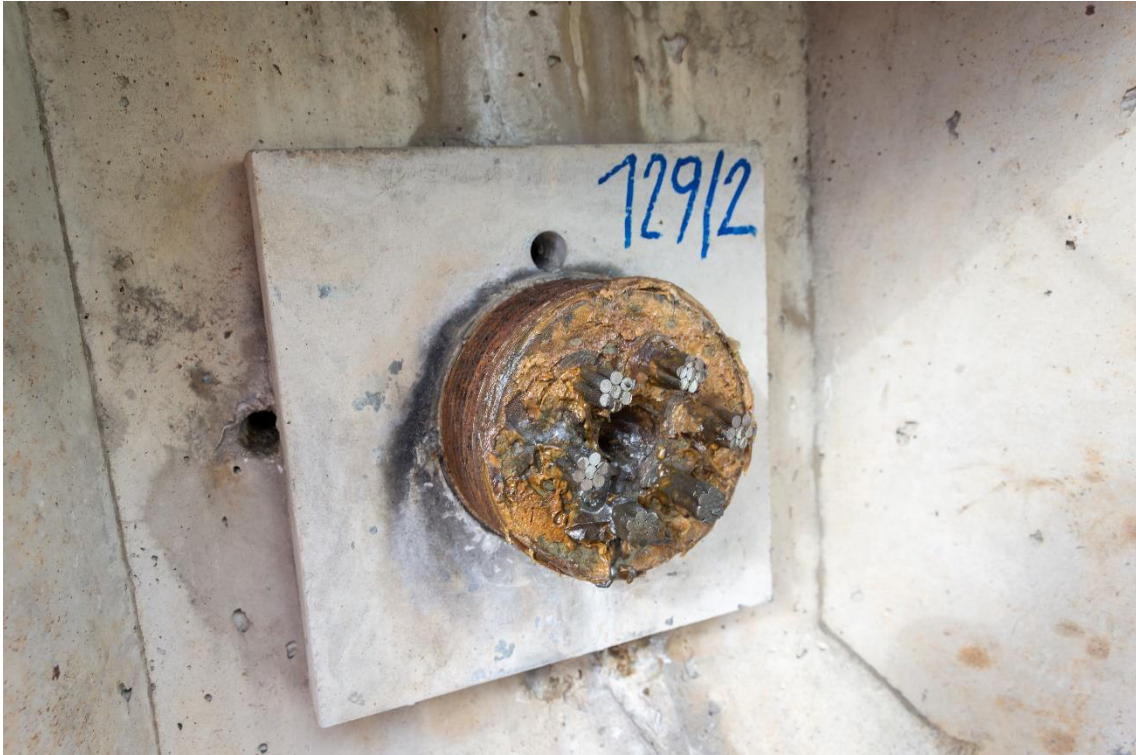
Abb. 27 Ankerkopf mit leicht korrodierter Verankerungsscheibe
