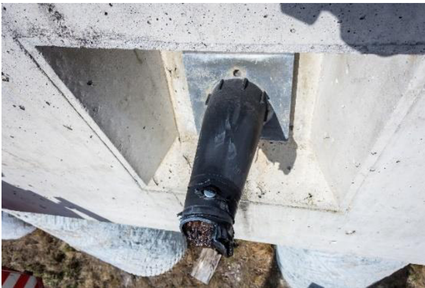
Abb. 41: Beschädigte Abdeckhaube eines Litzenankers
