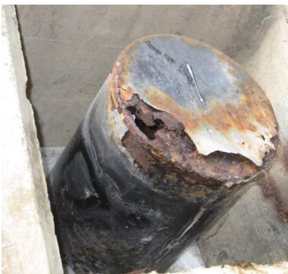
Abb. 42: Korrodierte Ankerkopfabdeckung aus Metall (Quelle: GDP ZT GmbH)
