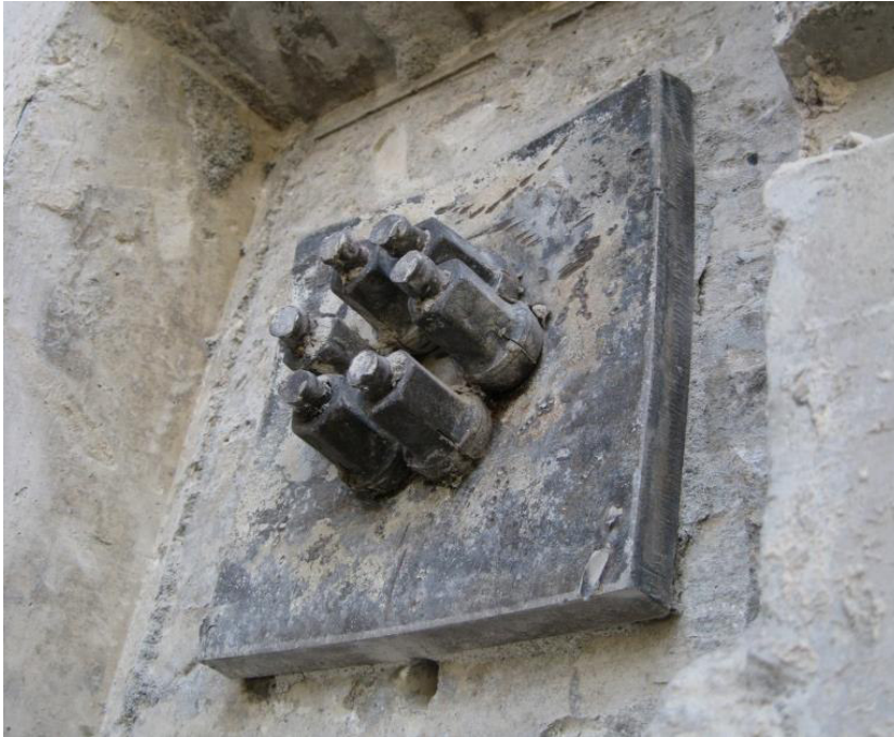
Abb. 36: Überbelasteter Ankerkopf (Quelle: GDP ZT GmbH)
