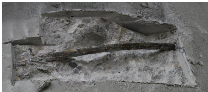
Bild 6.5: Freistimmen um die Bewehrung
