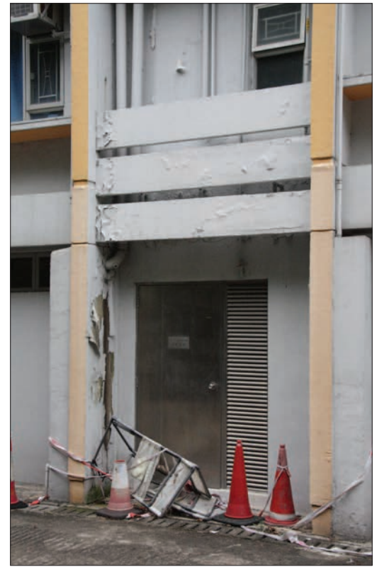
Abb.245: Detail von fassadenseitigen Baumängeln
