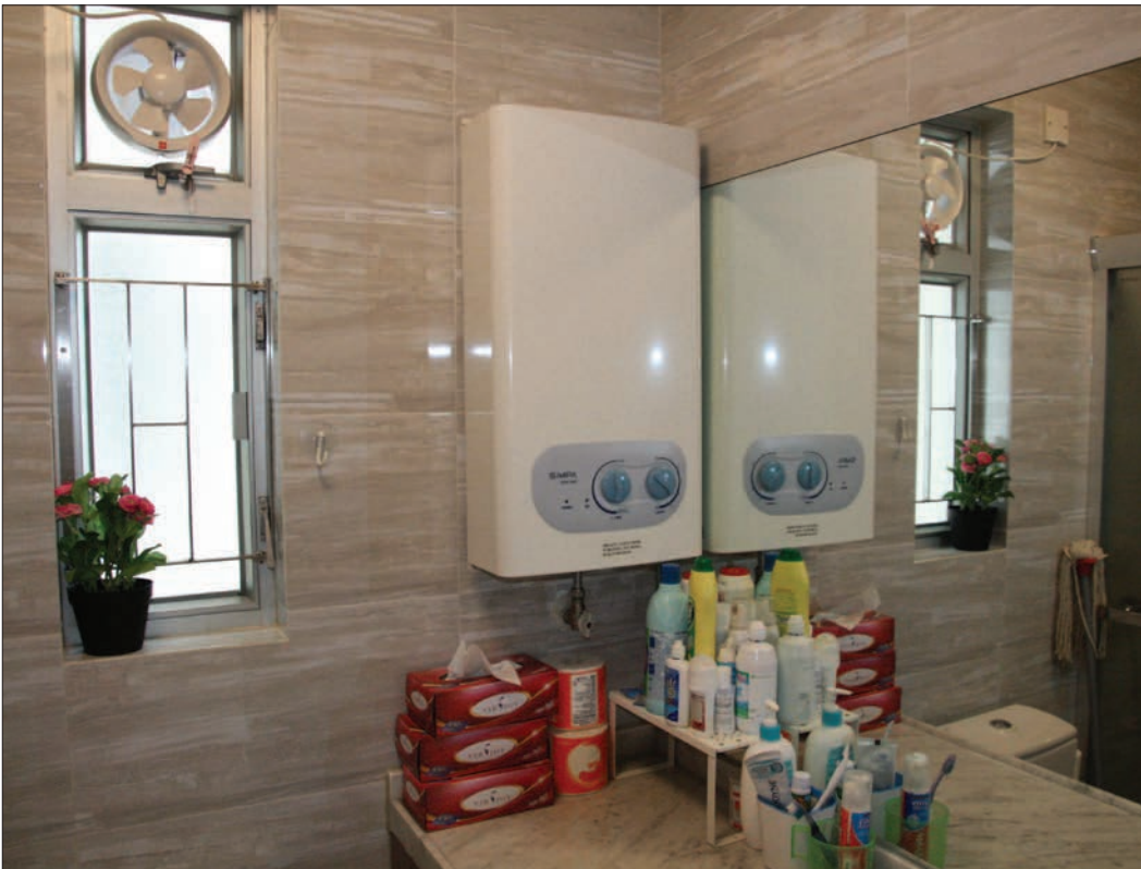
Abb. 60: Staufläche mit Boiler (1)
