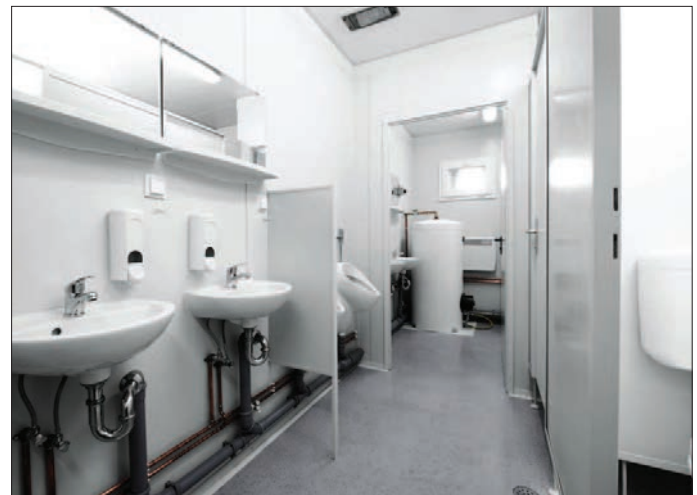
Abb. 437: Sanitärcontainer mit Toiletanlagen
