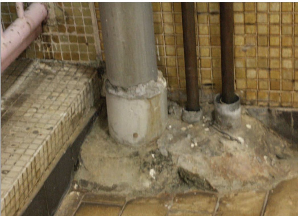
Abb. 145: Rohrdurchbrüche im Treppenhaus
