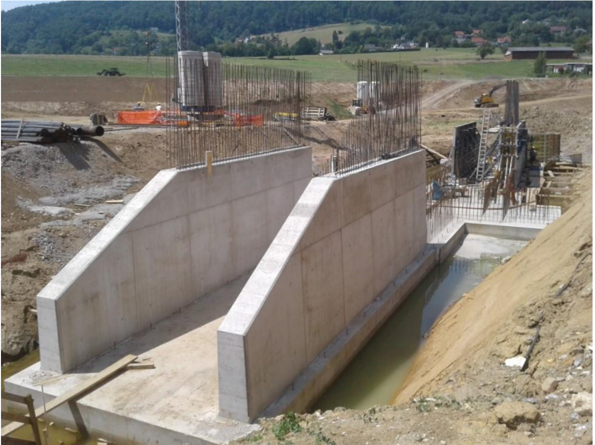
Abb. 126: RHB-Andritzbach: Durchlassbauwerk (Bild 1/2) [Q9]
