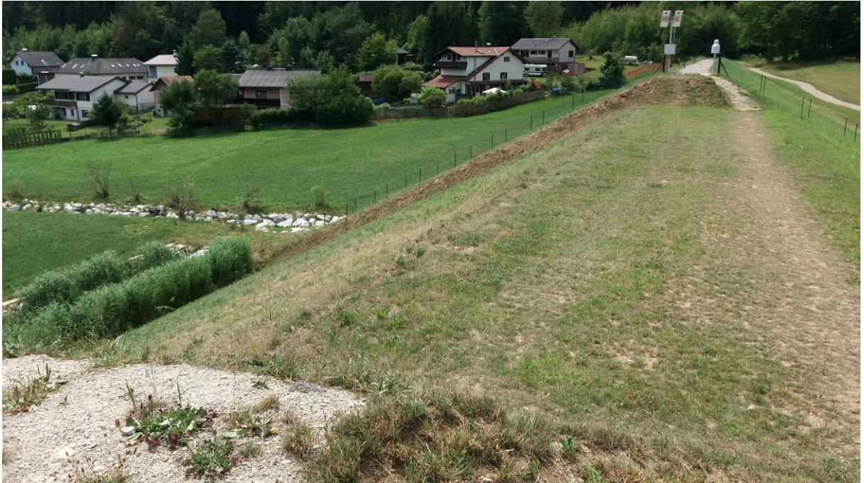
Abb. 114: RHB-Höllbach - Dammscharte und Tosbecken [Q4]
