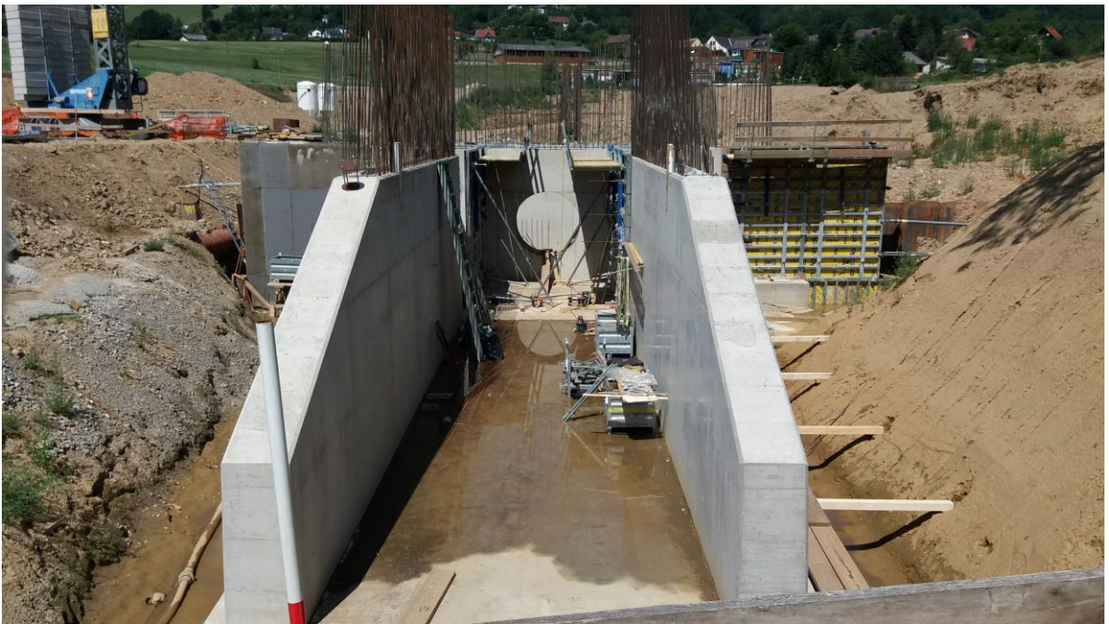
Abb. 127: RHB-Andritzbach: Durchlassbauwerk (Bild 2/2) [Q4]
