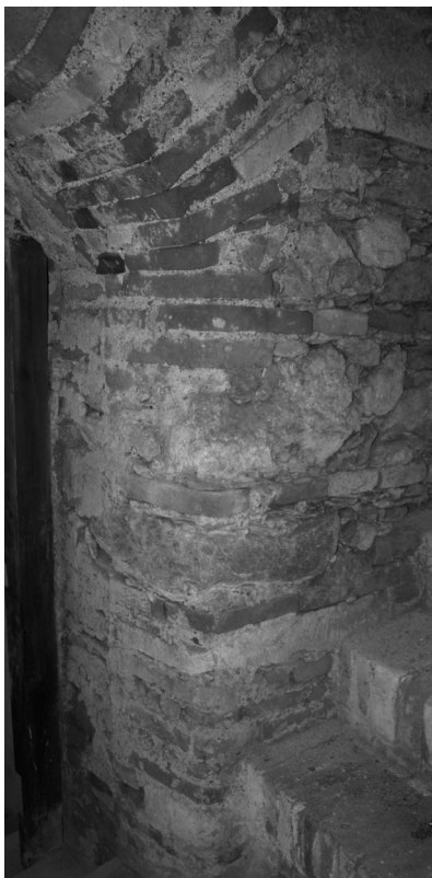
Abb.31: Mauer im Treppenhaus
