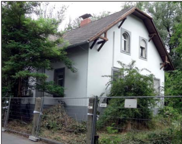
Abbildung 5 – Zustand der Villa Mohr (Schöckelbachweg 50), vollendet 1907 für Geschäftsdienner Martin Mohr, kurz vor ihrem Abriss 2015
