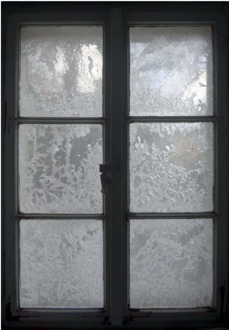
Abbildung 53 – Eisblumen an den Fensterscheiben, wie hier im Stiegenhaus der Villa Hochstrasser, erfreuen das Auge, zeigen aber auch den mangelnden winterlichen Wärmeschutz eines Fensters an.
