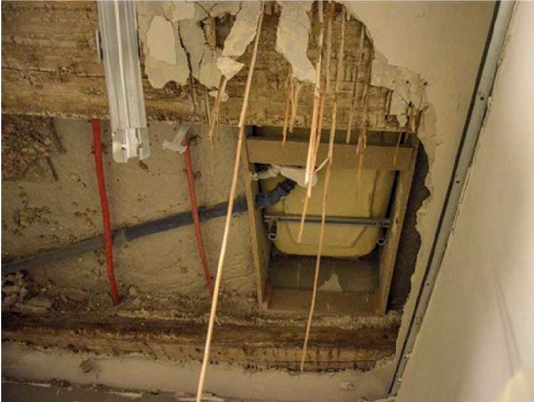
Abbildung 74 – Durchbruch einer Holzbalkendecke im Bereich einer Badewanne in einem Mehrparteienhaus
