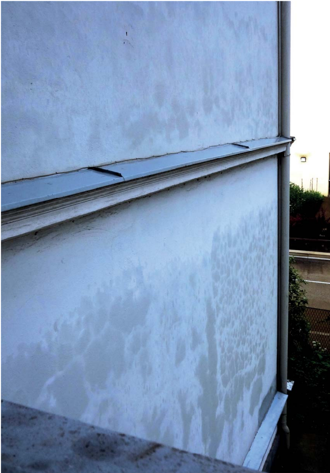
Abbildung 45 – Schlagregenereignisse führen regelmäßig zur Durchfeuchtung der Putzoberfläche. Der Bereich unterhalb des Stockwerkgesimses ist hier selbst bei starkem Schlagregen trocken geblieben.
