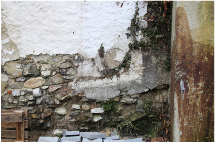
schadhafte Stelle an der Fassade
