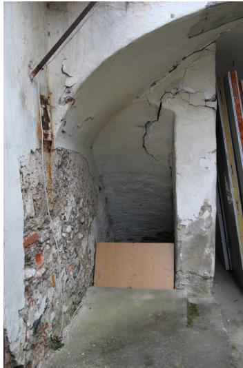
Abplatzungen und Risse in der Fassade und im Gewölbe des Durchgangs
