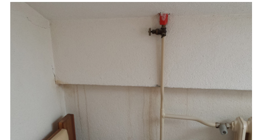
Slika 56. Zidovi soba oštećeni od vlage
