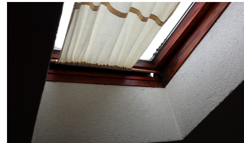
Slika 55. Krovni prozor sa oštećenjem od vlage
