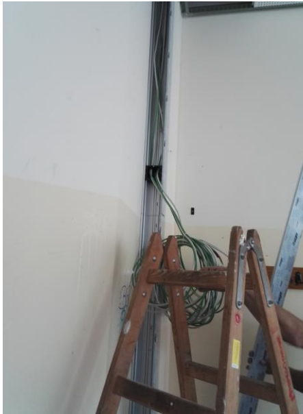
Abbildung 6-23: MG - Montierter Brüstungskanal mit Deckelschiene (rechter Bildrand)
