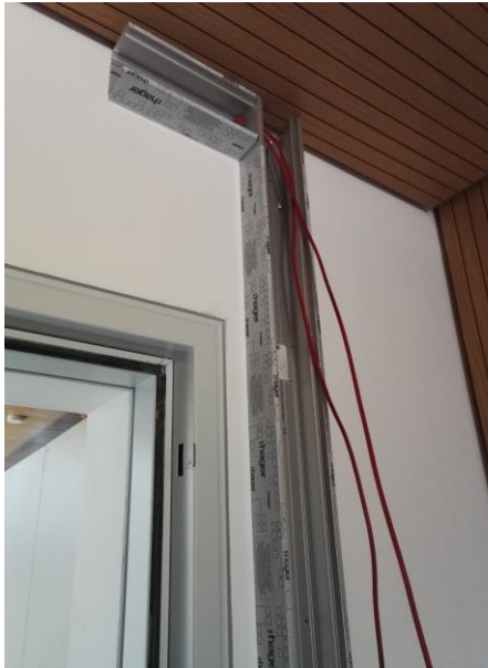
Abbildung 6-12: MG - Montierter Brüstungskanal
