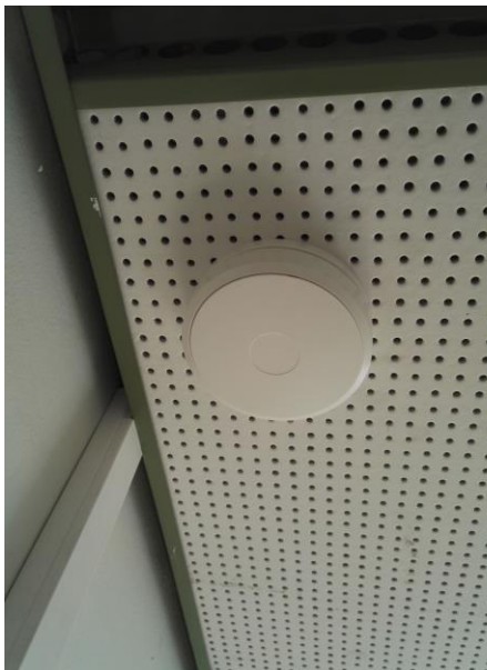
Abbildung 6-36: MG - Montierter Rauchmelder
