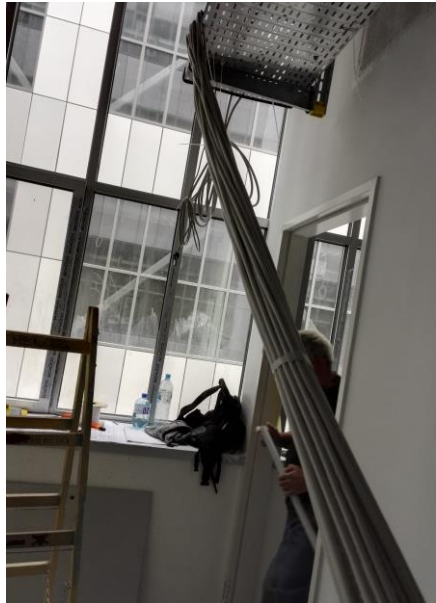
Abbildung 5-25: MC - Kabelstrang IT-Übertragungskabel
