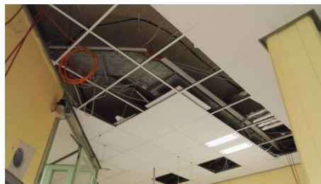
Abbildung 6-2: MG - Brandmeldeleitung in abgehängter Decke
