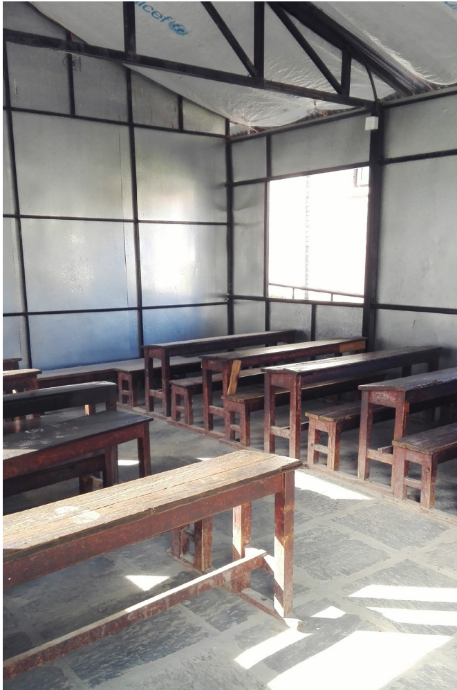
Abb. 75: Lernzentrum der „Patan Higher Secondary School“, Kathmandu, 09/2016, Klassenzimmer aus Holz und Stahlblech
