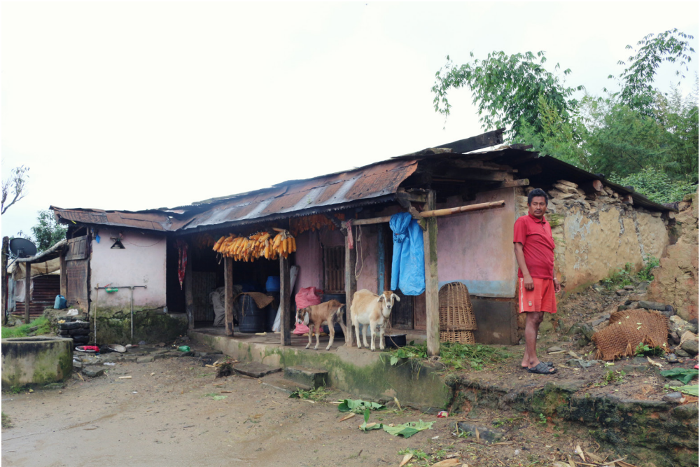
Abb. 76: Haus einer 6-köpfigen Familie, welches beim Erdbeben 2015 beschädigt wurde, 10/09/2016
