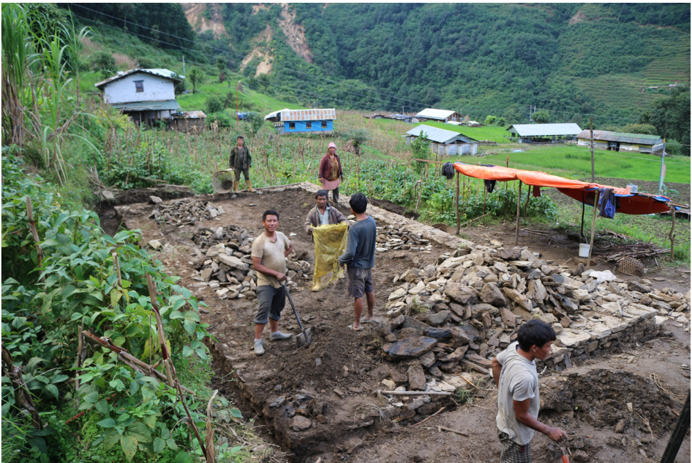
Abb. 83: Bau eines neuen Wohnhauses; das Fundament wird von einigen Bewohnern des Dorfes aus Steinen errichtet, 14/09/2016
