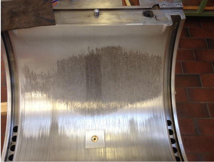
Abbildung 4-11: Defekte Lagerschale verursacht durch Wellenstromfluss (Quelle: Andritz Hydro)
