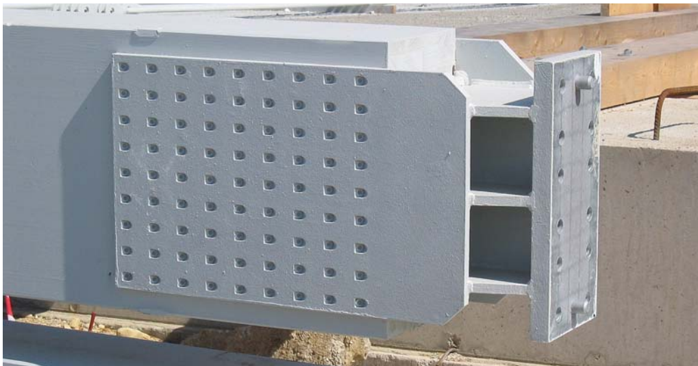
Abb. 1.1: Laschen und Kopfplatte für die Verbindung im Stoß des Fachwerk-Untergurtes der Überdachung des VIP-Hangars am Flughafen Wien (Foto: G. Meinhardt)
