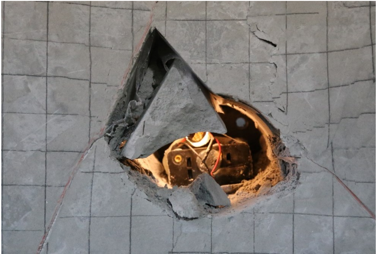
Abbildung 31 MV10 – Herabfallen des Blockes nach dem Entfernen der Plexiglasscheibe
