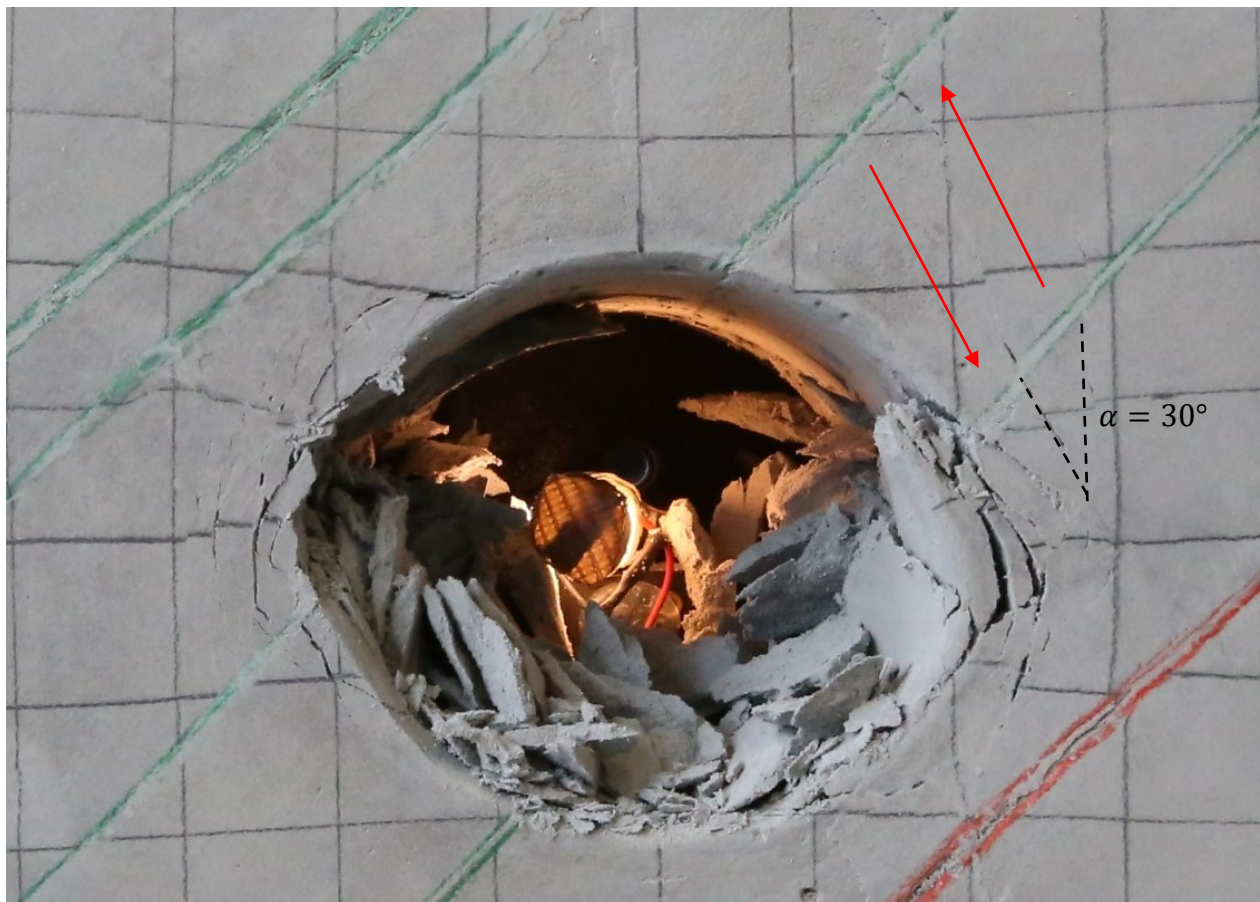
Abbildung 36 MV12 – Endzustand, Harnischfläche (rot), Trennfläche (grün), Scherbewegung (rote Pfeile)
