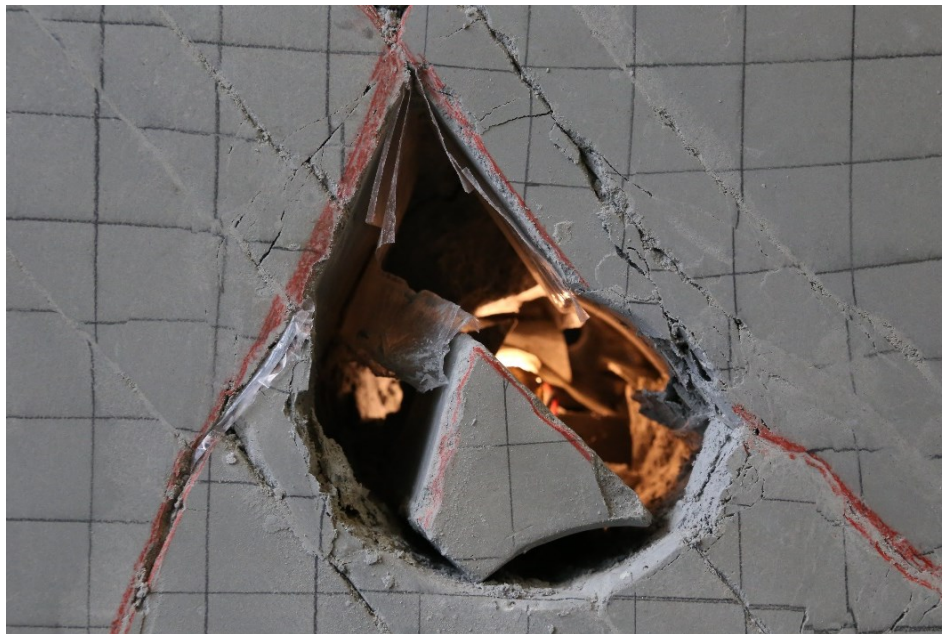
Abbildung 35 MV11 - Herabfallen des Blockes in der Firste
