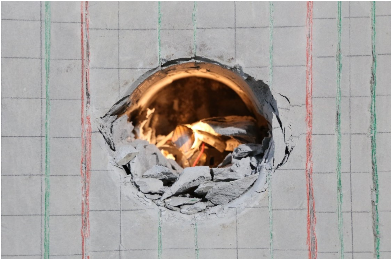
Abbildung 15 MV3 – Endzustand, Harnischflächen (rot), Trennflächen ohne Kunststoffeinlage (grün)
